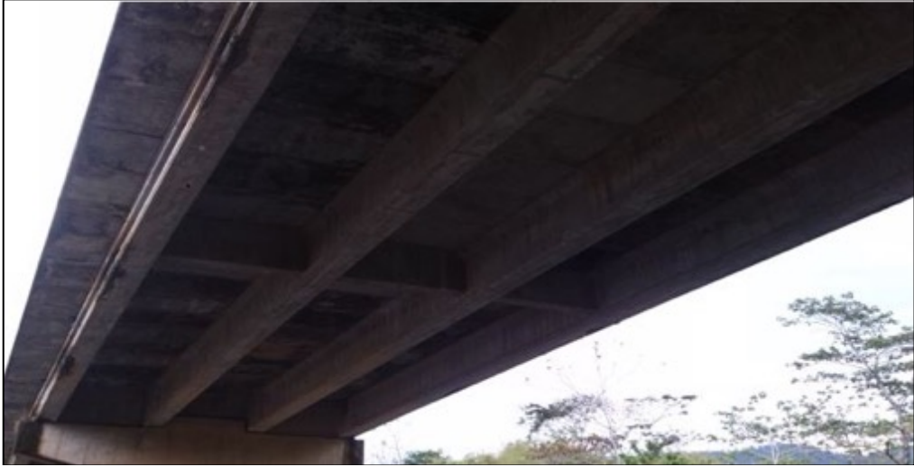
Figura 40. Puente Rio Uvita Vista inferior superestructura. Fuente: www.mopt.go.cr , aplicación SAEP. Inventario de puentes rutas nacionales
