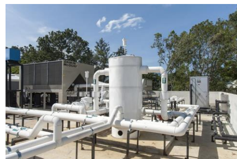
Descripción: casa de máquinas. Proyecto: radioterapia Hospital México.
