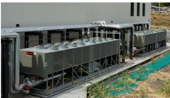
Descripción: casa de máquinas. Proyecto: Micro Vention fase II.
