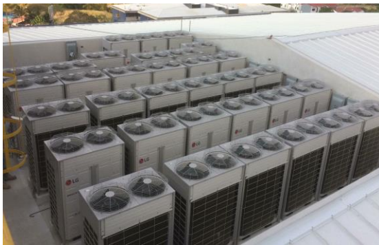
Descripción: condensadores VRF. Proyecto: edificio Dipoa.
