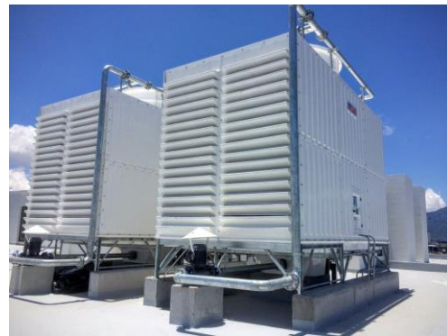
Descripción: torres de enfriamiento. Proyecto: oficentro Asebanacio.
