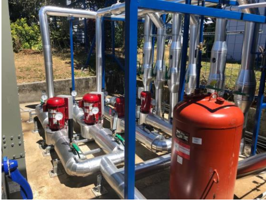
Descripción: casa de máquinas. Proyecto: mejoras AyA.
