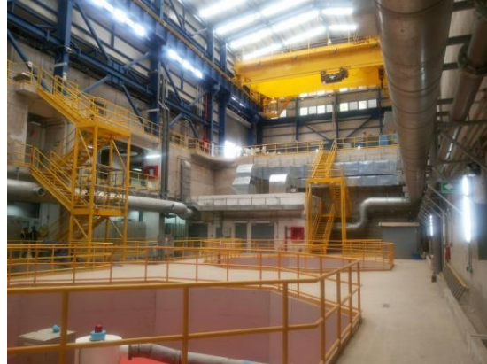
Descripción: ductos de ventilación. Proyecto: hidroeléctrica Chucas.
