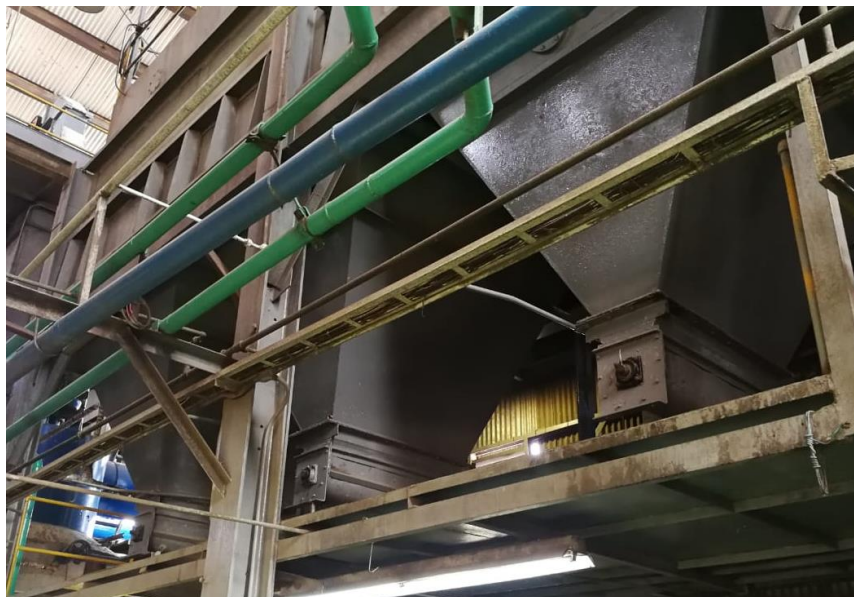
Figura 3-4. Tolvas de alimentación. Fuente. Coopevictoria R.L.
