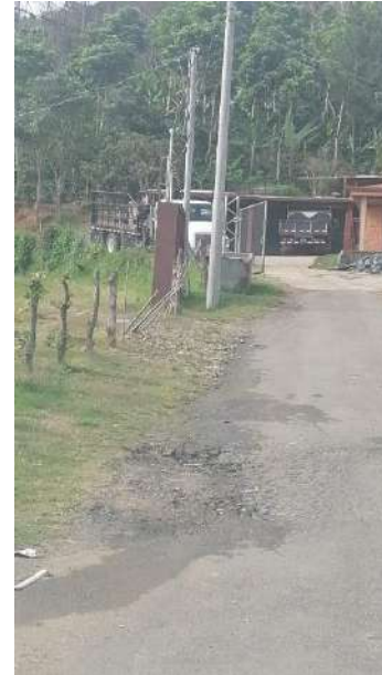
Figura 25. Hueco en camino 3-08-026. Fuente: Elaboración propia utilizando la cámara del celular.
