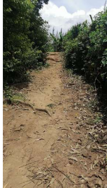
Figura 94. Drenajes en camino 3-08-235. Fuente: Elaboración propia utilizando la cámara del celular.
