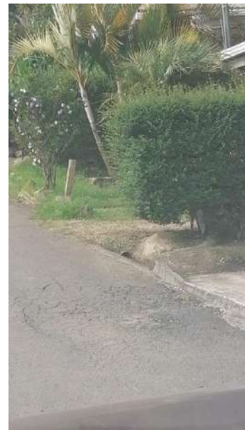
Figura 26. Drenajes en camino 3-08-026. Fuente: Elaboración propia utilizando la cámara del celular.
