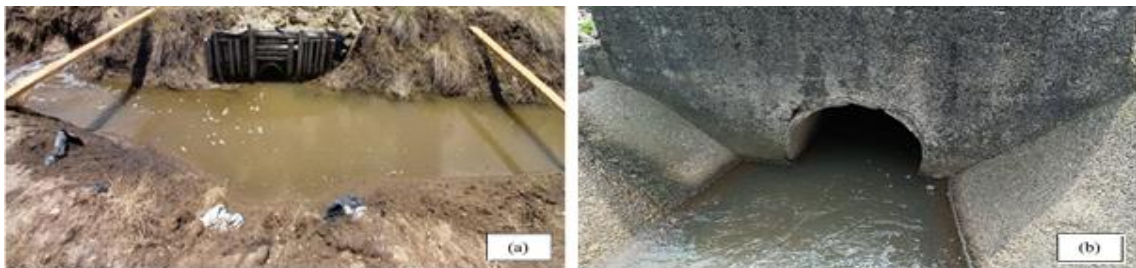
Figura 4.11. Obras para medición de caudal de drenaje para Lote Piches (a) y Lote Inés (b)
