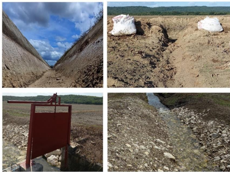
Figura 4.8. Infraestructura de riego – drenaje
