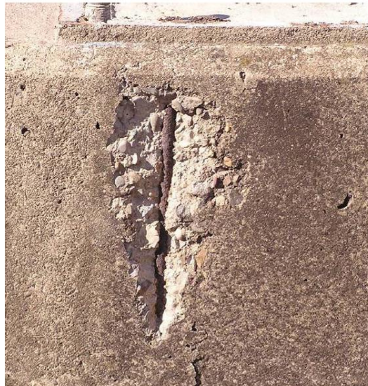
Figura. 1.2. Carbonatación del concreto y consecuente descamado.
