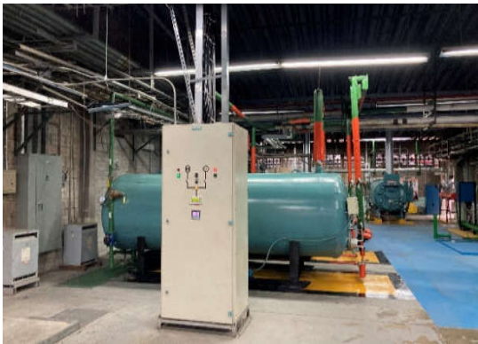
Figura 26. Vista interior del equipo mecánico.
