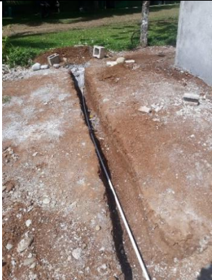
Foto 3. Profundidad insuficiente de previstas de agua potable. Visita 1
