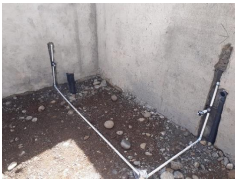
Foto 5. Material de tuberías mecánicas adecuado. Visita 1
