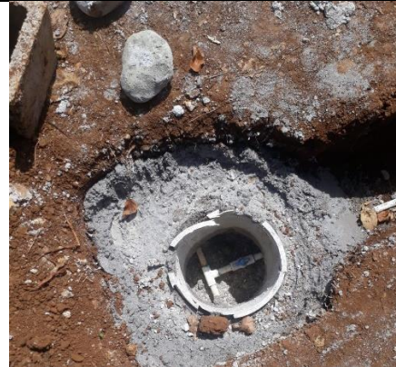
Foto 4. Válvulas de tuberías provistas de cajas de registro. Visita 1
