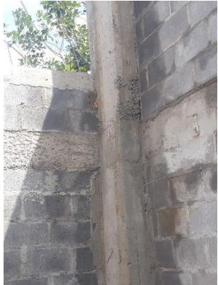
Foto 1. Hormigueros en columna de concreto. Visita 1
