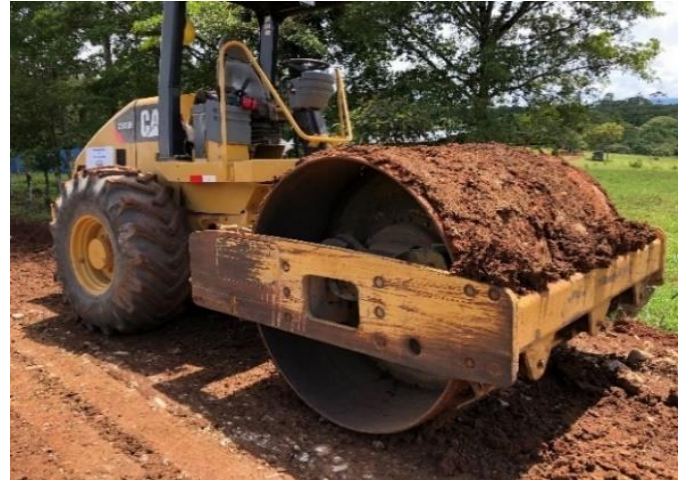
Figura 57. Problemas de compactación. Fuente: fotografía capturada por el autor.
