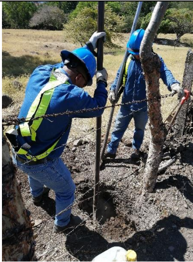
Figura 4. Liniero sin energía en labores de realizar el hueco para el anclaje del poste.
