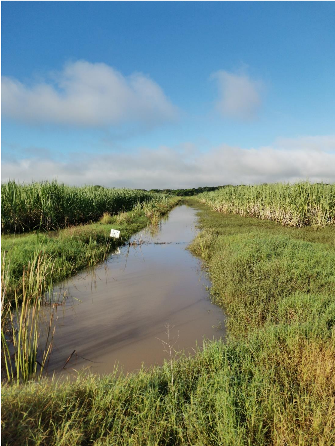
Figura 41. Estado de los drenes en Sector Salimas antes de la construcción de tapones y limpieza en los drenes de desagüe.
