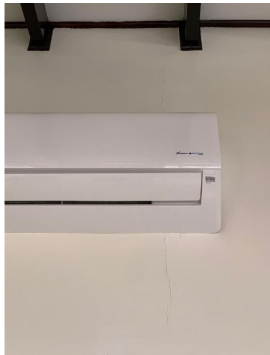
Figura 14. Fisura en muros de las villas tipo 509 al 514. Fuente: Elaboración propia.
