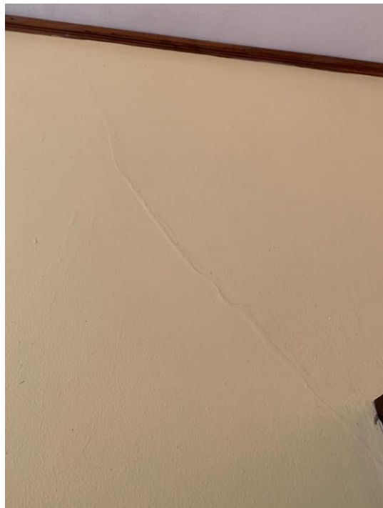
Figura 3. Fisura de muros de la villa tipo 202-207 Fuente: Elaboración propia.
