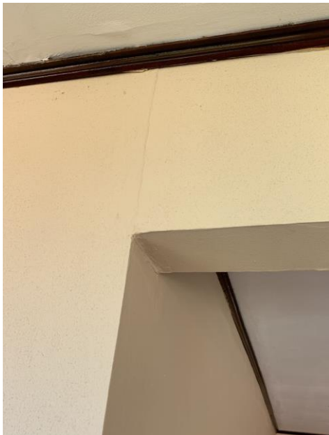
Figura 26. Fisuras en vigas del hotel. Fuente: Elaboración propia.
