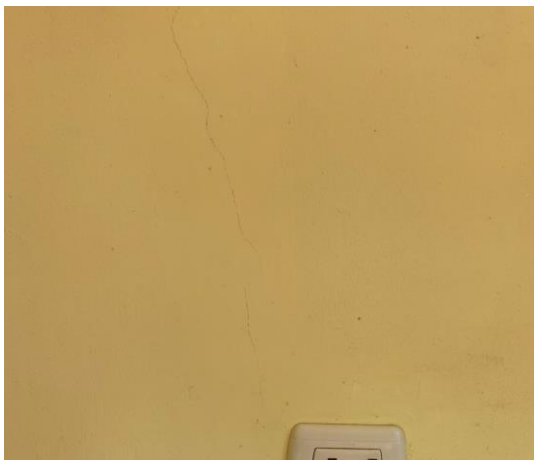
Figura 6. Fisura en la cocina de la villa del tipo 913-920 Fuente: Elaboración propia.
