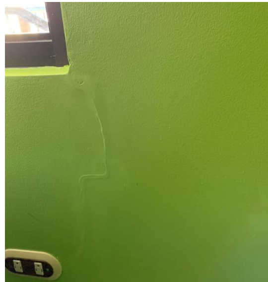
Figura 23. Fisuras en los muros de las villas tipo Suite. Fuente: Elaboración propia.
