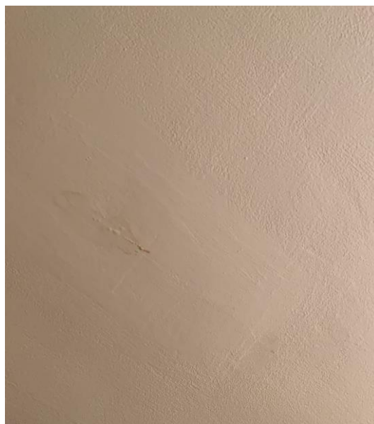
Figura 29. Fisura del Gypsum en el cuarto del hotel.
