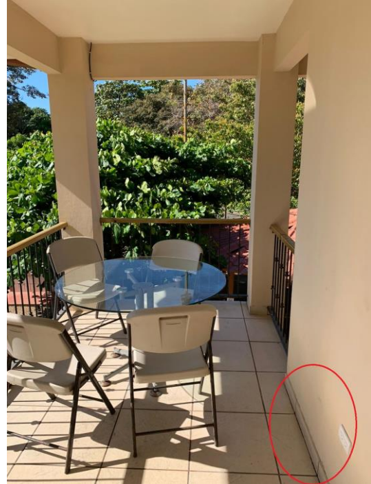
Figura 4. Fisura de muro y balcón de la villa tipo 411-416 Fuente: Elaboración propia.
