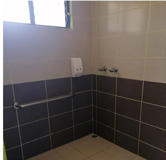
Figura 24. Dispositivos y accesorios de seguridad en la villa. Fuente: Elaboración propia.
