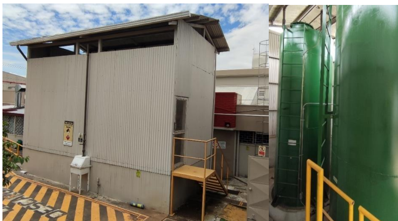
Figura 5.1.1. Ubicación y descripción gráfica de los tanques de diésel de la empresa Hilos. Fuente: elaboración propia.
