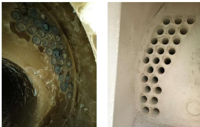
Figura 5.3.2.2. Vista del interior de la caldera con una mala y buena planeación de limpieza en el mantenimiento preventivo. Fuente: Sincal [54].
