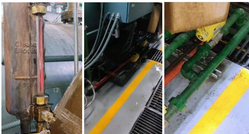
Figura 6.2.5.2. Fuga de agua en sensor de columna caldera 200 BHP. Fuente: elaboración propia.
