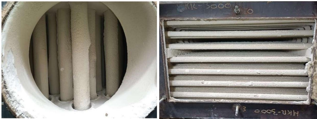
Figura 5.3.2.1. Vista interna previo a realizar la limpieza de ceniza del ciclón, el economizador y el paso de humos de la caldera. Fuente: Sincal [54].
