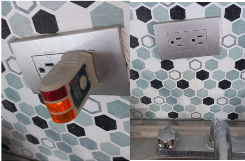
Figura 5: Tomacorrientes comedor oficinas administrativas y probador de salida GFCI [Elaboración propia].
