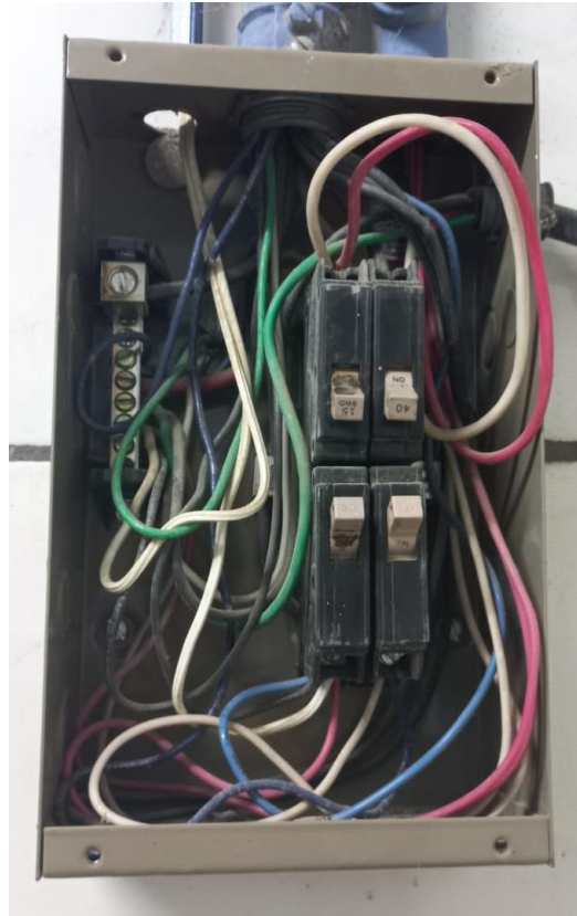
Figura 4: Tablero Oficina de Gerencia [Elaboración propia].
