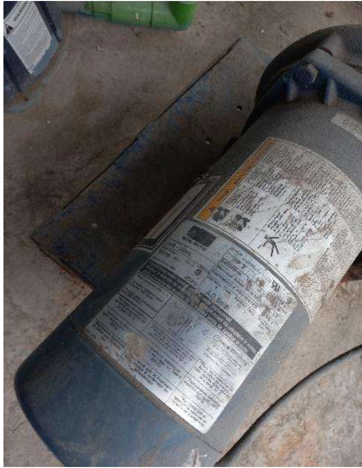
Figura 92. Sistema de bombeo de agua para baños Fuente: Elaboración propia (2023).
