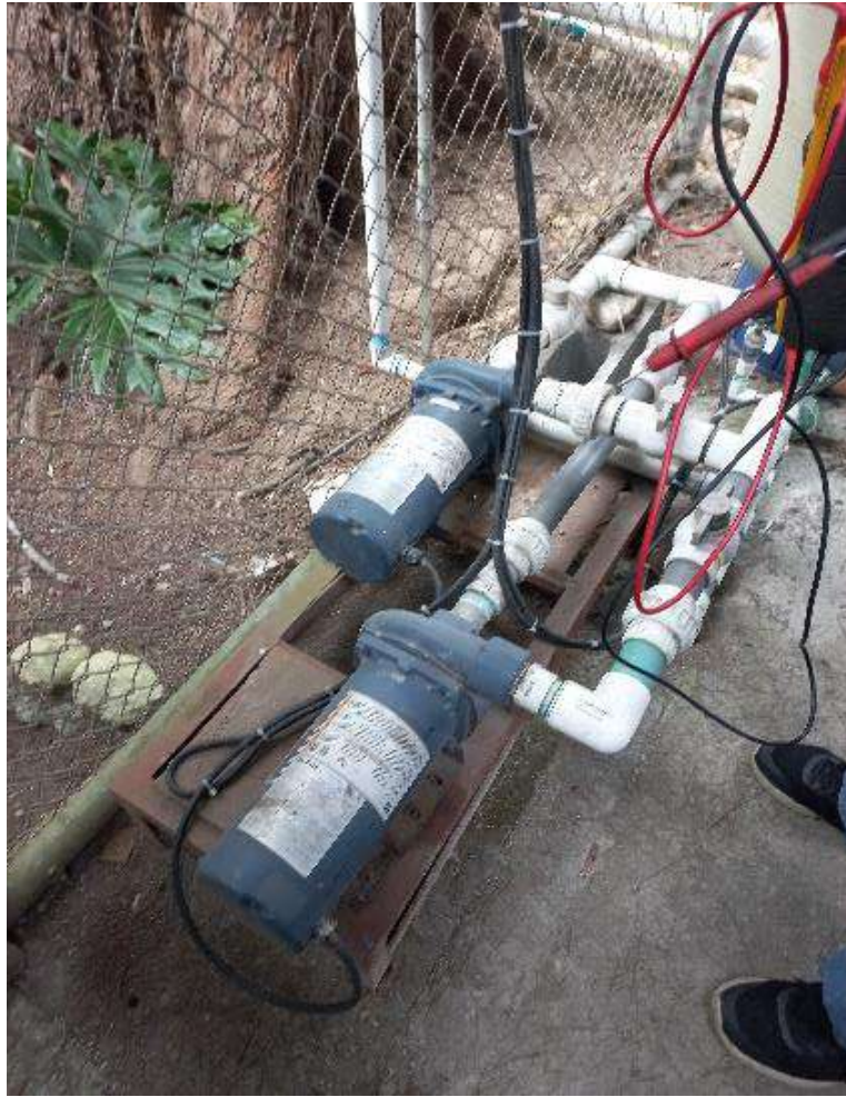
Figura 88. Bomba de sistema de agua potable Planta Fuente: Elaboración propia (2023).
