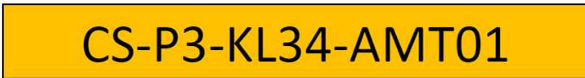
Figura 9. Etiqueta de identificación Alimentador principal de media tensión
