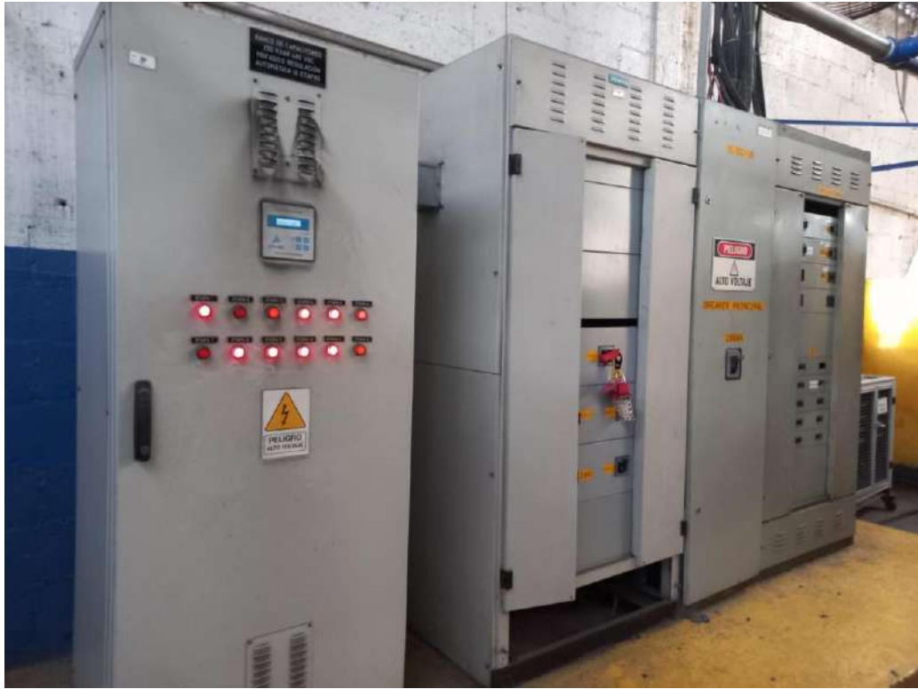
Figura 83. Subestación principal y Banco de capacitores Planta 3 Fuente: Elaboración propia (2023).
