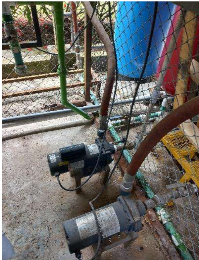
Figura 91. Sistema de bombeo de agua para baños Fuente: Elaboración propia (2023).
