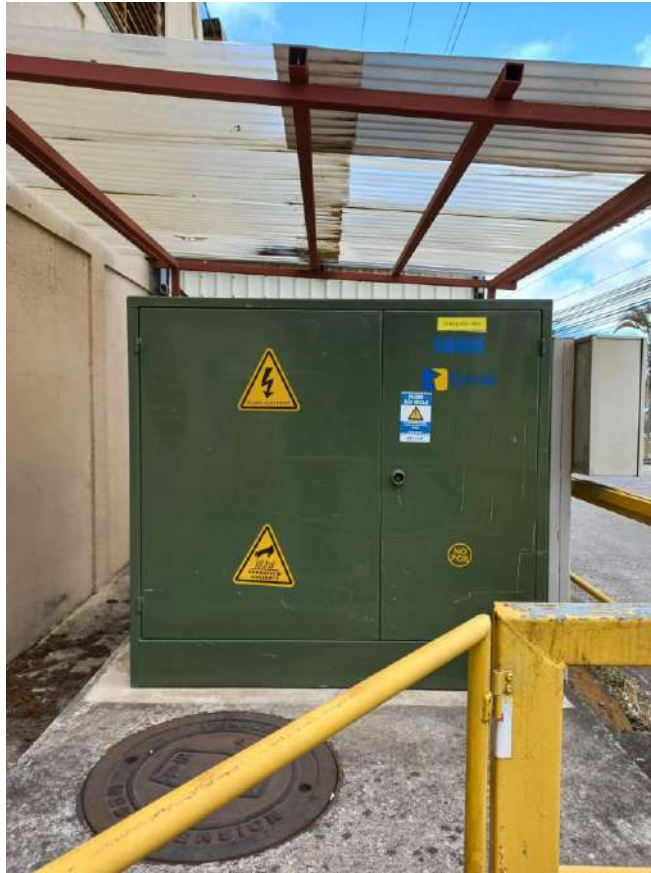
Figura 81. Transformador principal, Planta 3 Fuente: Elaboración propia (2023).
