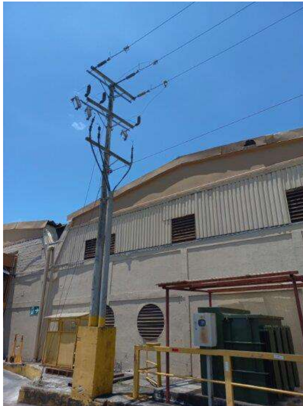
Figura 10. Transición aéreo-subterránea de acometida JASEC
