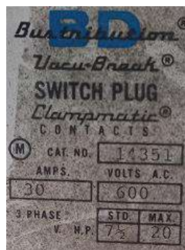
Figura 14. Datos de placa de fusibles en ducto barras
