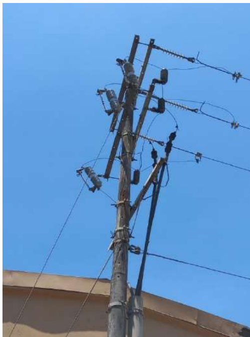
Figura 82. Protección Acometida, cuchilla porta fusibles Fuente: Elaboración propia (2023).
