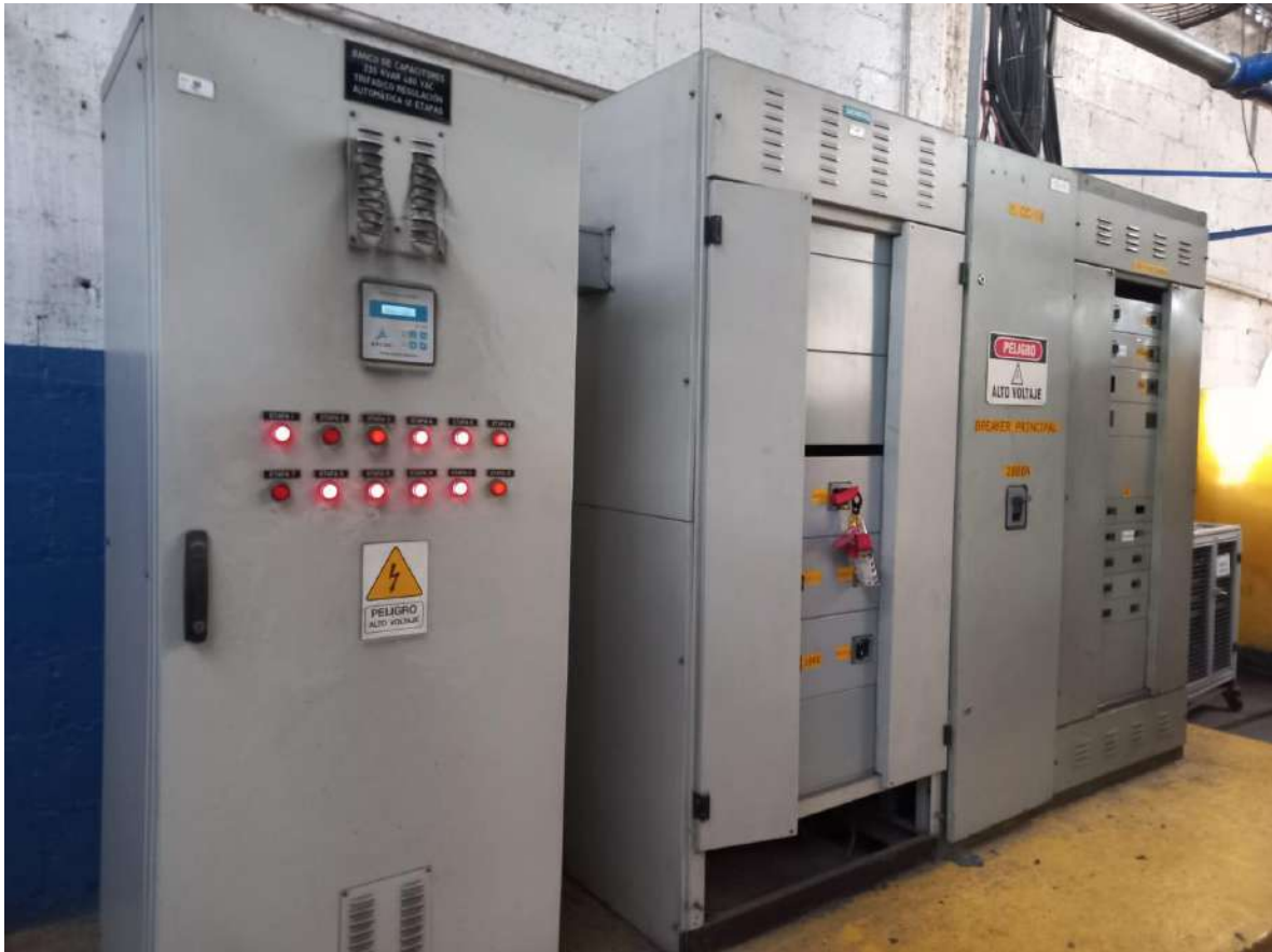
Figura 12. Subestación Principal 480V
