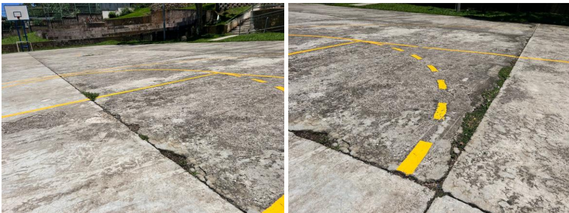
Figura 48. Estado de losa de Cancha multiuso Parque de San Vicente
