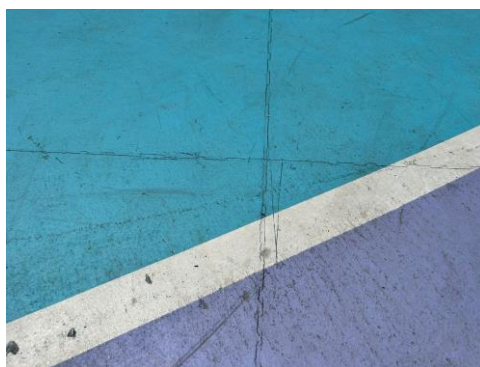
Figura 28. Agrietamientos en Cancha multiuso Parque Central de Escazú
