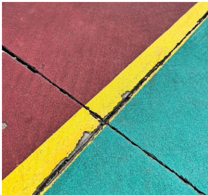
Figura 17. Agrietamientos en Cancha multiuso Parque Recreativo y Deportivo de Santa Ana
