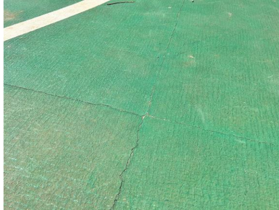
Figura 7. Agrietamientos en Cancha multiuso Parque Urbano Juan Rafael Mora Porras
