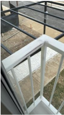
Figura 49. Estructura balcón mal acabada.
