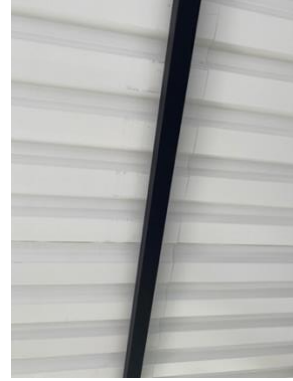
Figura 52. Cubierta de techo de cochera manchada y golpeada.
