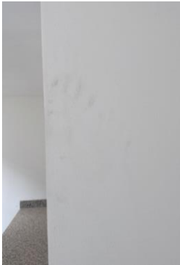
Figura 30. Pintura manchada en paredes.
