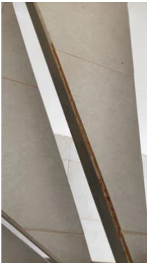
Figura 41. Fragua faltante en gradas.
