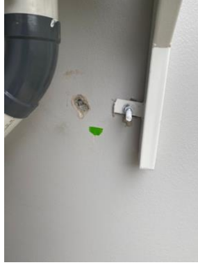
Figura 50. Estructura de pila mal acabada.
