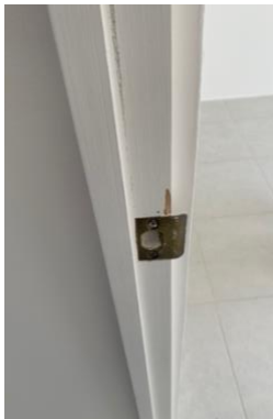
Figura 31. Marco de puerta golpeado.
