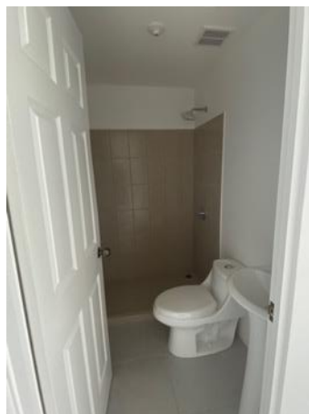
Figura 25. Servicio sanitario planta alta.
