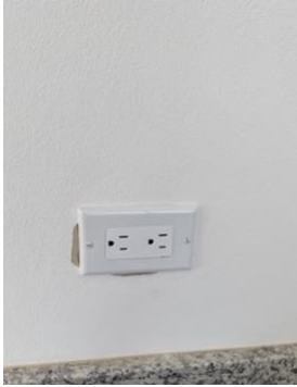
Figura 19. Repello quebrado borde plaquería.
