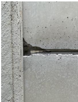
Figura 22. Baldosas de tapia quebradas.
