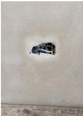
Figura 12. Repello borde cajas eléctricas.
