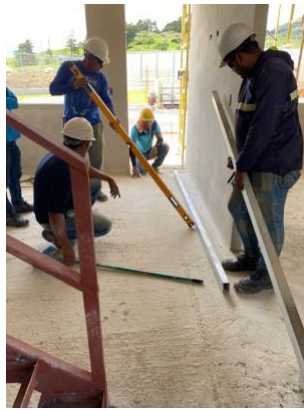
Figura 55. Capacitación del personal responsable de losas de fundación, entrepiso y piso cerámico.
