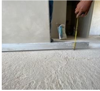
Figura 49. Revisión del procedimiento de medición de la Planicidad.
