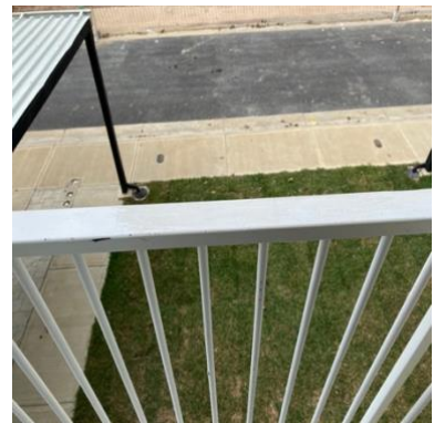
Figura 28. Pintura estructura balcón.
