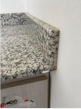
Figura 39. Mueble de cocina manchado.
