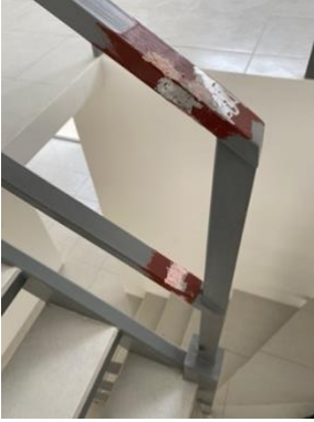
Figura 48. Estructura de grada mal acabada.
