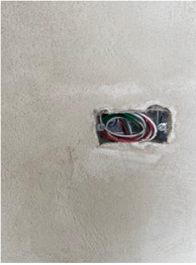
Figura 10. Repello borde cajas eléctricas.
