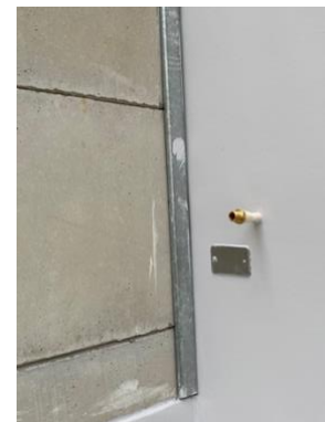
Figura 38. Estructura tapia manchada.
