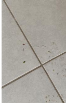
Figura 42. Piso cerámico quebrado.
