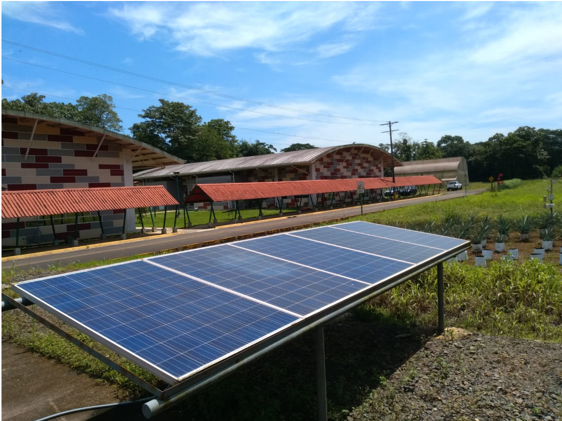
Figura C.2: Paneles solares utilizados en el proyecto.
