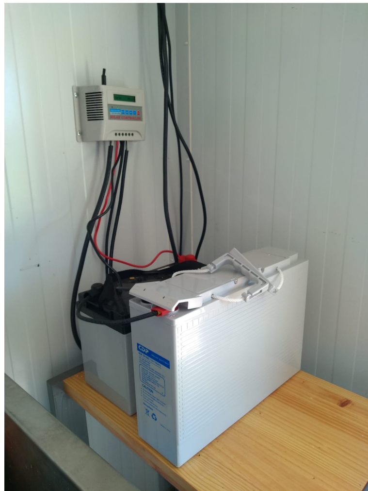
Figura C.1: Conexión del regulador de carga y las baterías.
