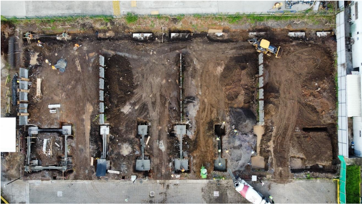
Figura 22. Placas aisladas y vigas de fundación Eje 1 y 2 Proyecto Bodegas Unifika de Lindora.
