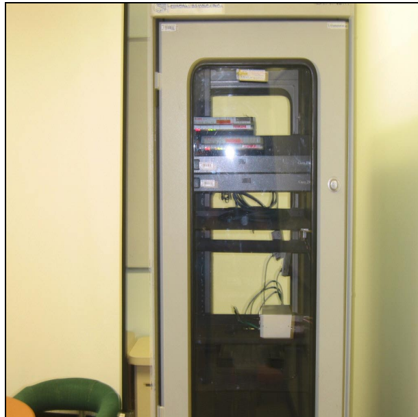
Figura 3.2 Sistema de alarma SMR- NET 8900 instalado en un armario de equipo de redes del banco.
