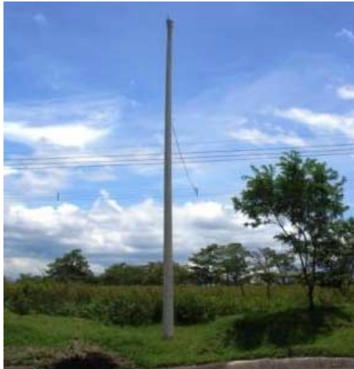
Figura A.4.22 Poste primario de electricidad a 30 m de las válvulas
