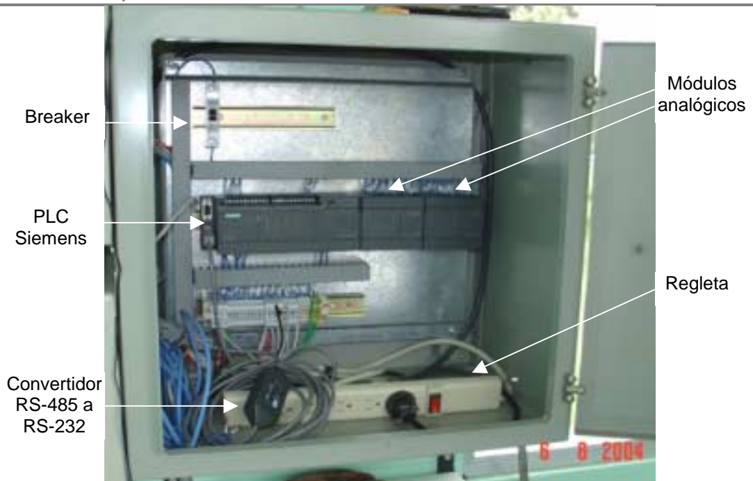
Figura A.4.15 Gabinete del PLC.
