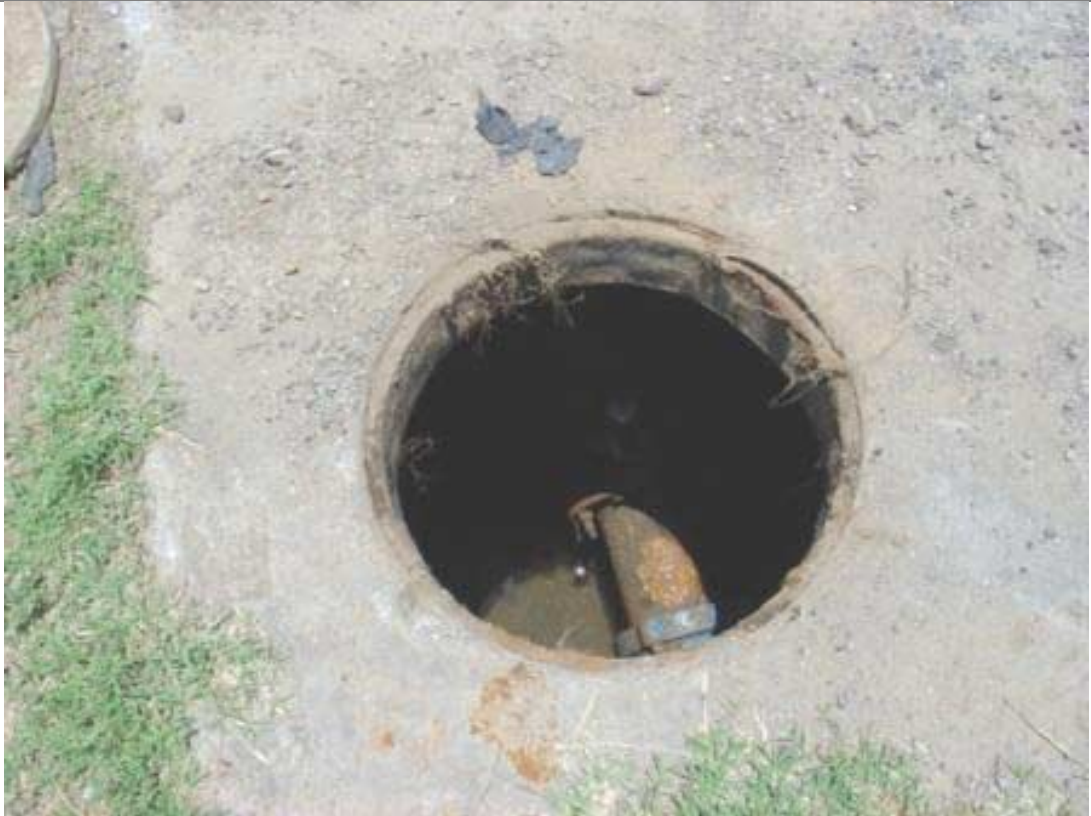
Figura A.4.24 Contenedor del medidor de caudal
