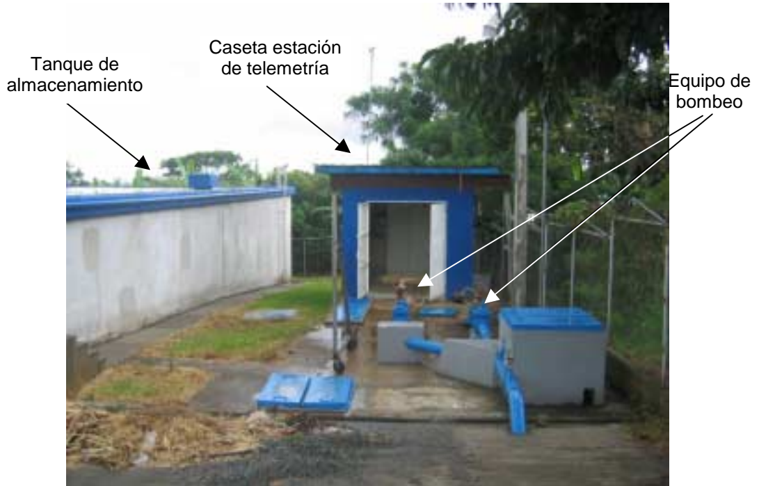
Figura A.4.1 Tanque y bombeo de la estación remota
