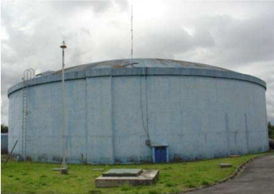
Figura A.4.17 Tanque Bello Horizonte 1
