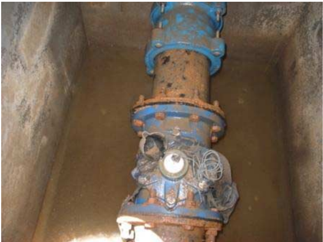
Figura A.4.25 Tubería con medidor de caudal mecánico-eléctrico.
