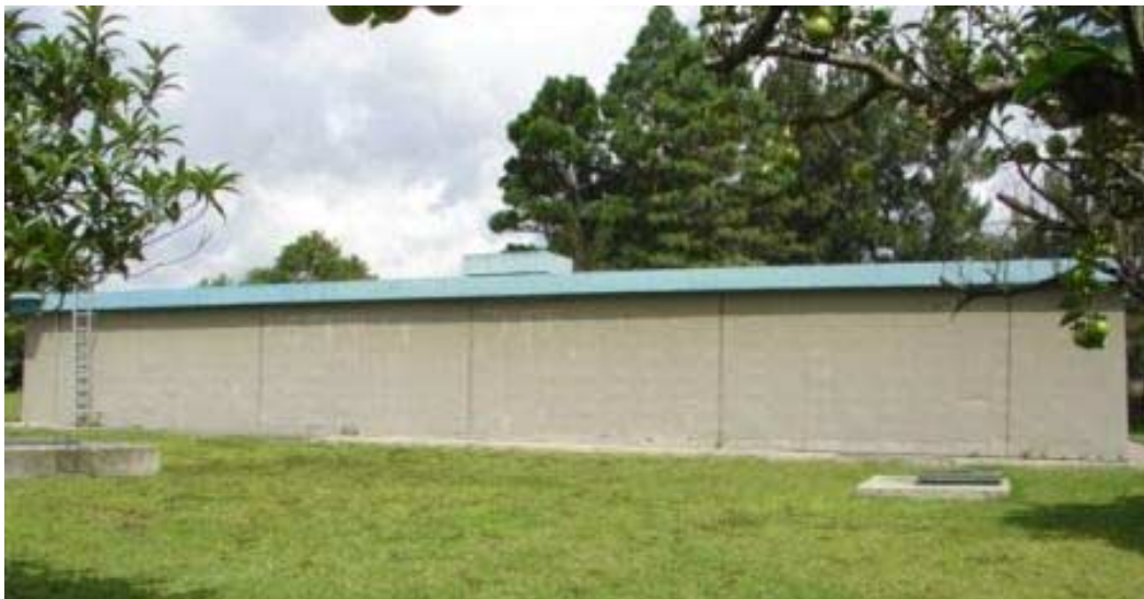
Figura A.4.18 Tanque Bello Horizonte 2
