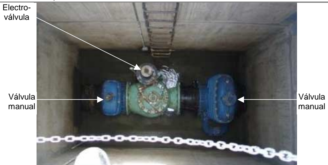
Figura A.4.19 Electro válvula junto con dos válvulas mecánicas.
