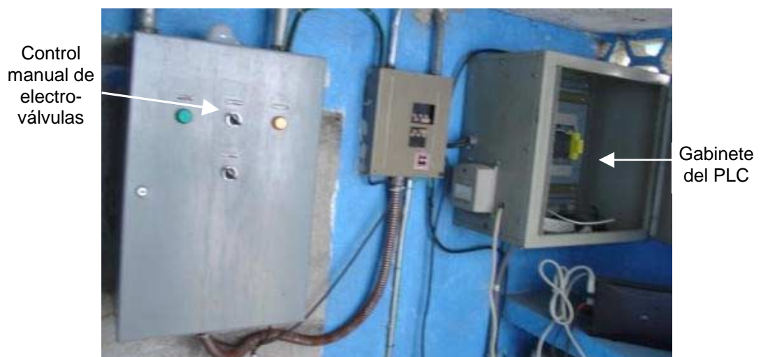
Figura A.4.21 Control de electroválvula y gabinete del PLC.
