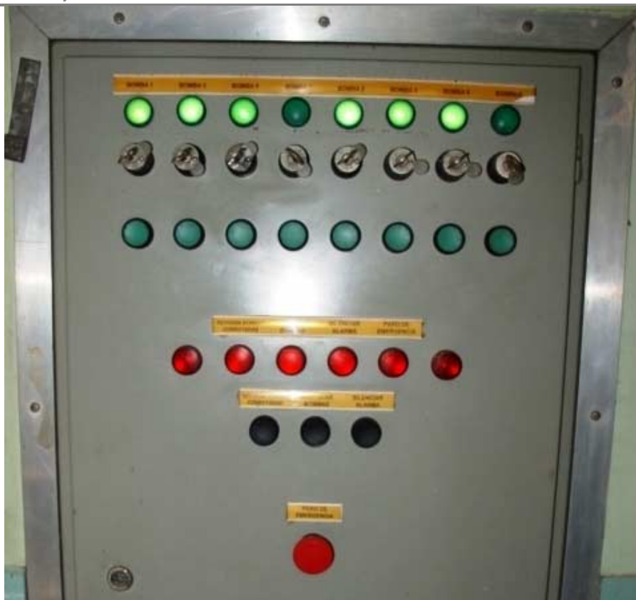
Figura A.4.7 Control manual ON/OFF de las bombas
