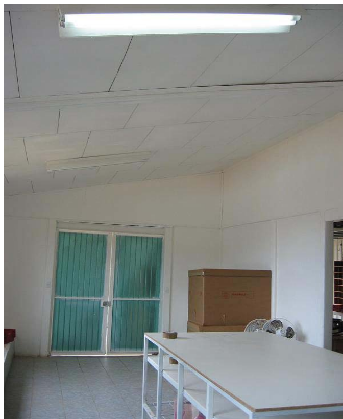
Figura # 19. Iluminación con fluorescentes.
