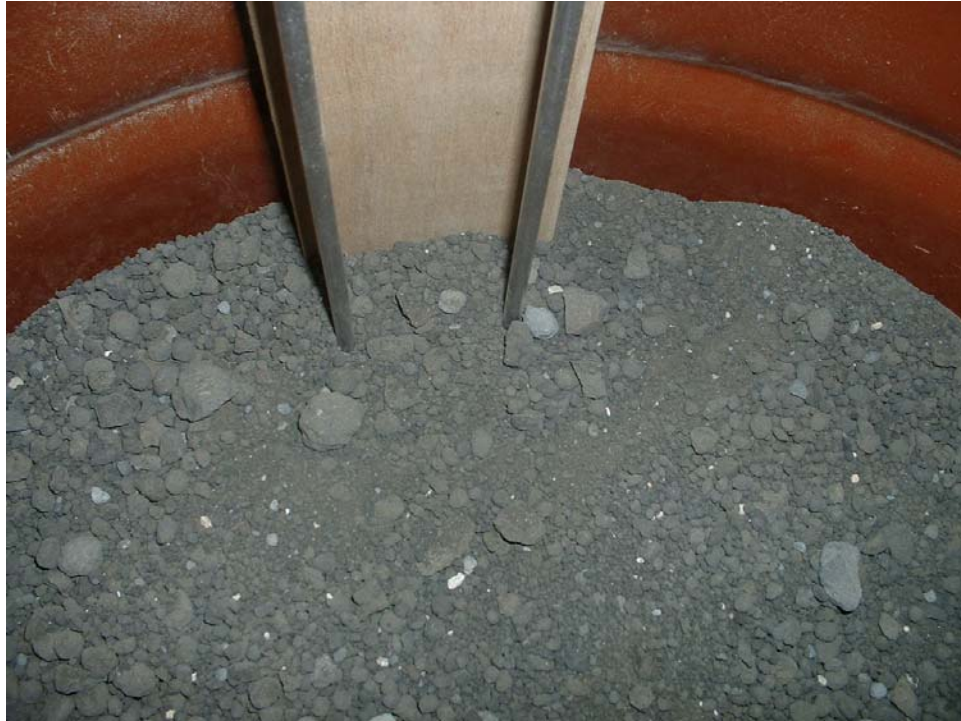
Figura A.3. 3 Detalle del clinker acumulado entre los conductores de la línea de transmisión
