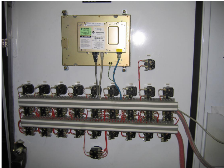
Figura 6.3 Vista interior de la puerta del panel de control
