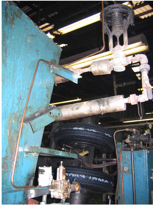
Figura 5.13 Regulación de presión de la válvula mecánica por el transductor
