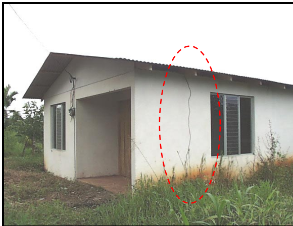
Figura 15. Agrietamiento de paredes.
