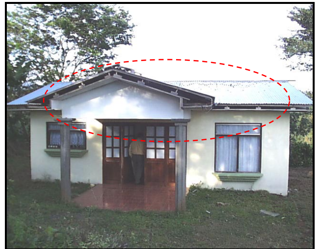
Figura 17. Acabado final de alero deficiente.
