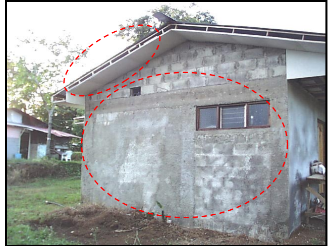
Figura 16. Deficiencias de repello y acabado final de aleros.
