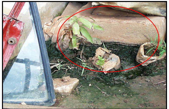
Figura 24. Sistema de evacuación de aguas pluviales deficiente.
