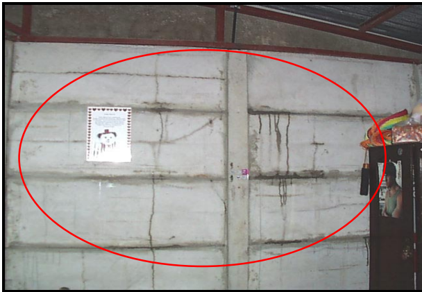
Figura 20. Agrietamiento y presencia de humedad en pared.
