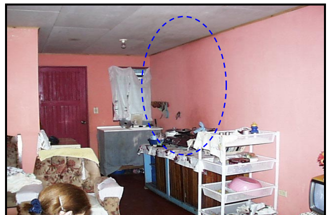
Figura 18. Presencia de humedad en pared.
