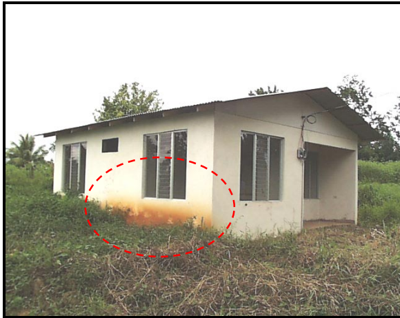
Figura 14. Falta de canoas provoca la coloración en las paredes.
