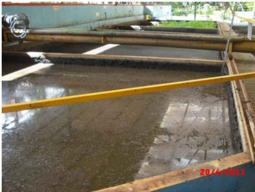
Fotografía 5-4. Filtro lento de lodo anaerobio estabilizado.
