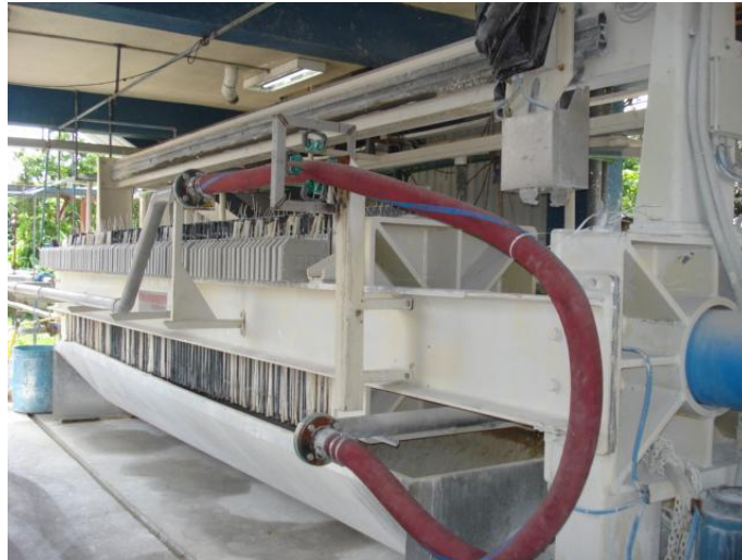
Fotografía 2-9. Filtro prensa utilizado para la deshidratación del lodo.
