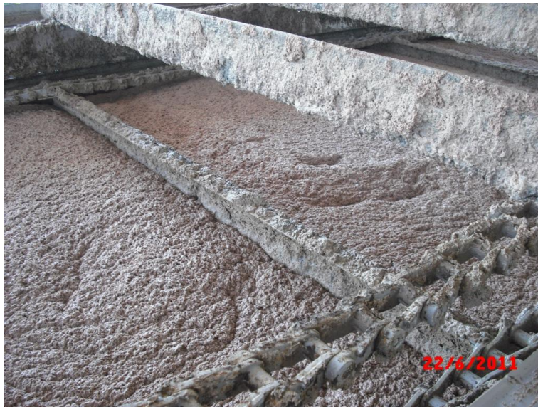
Fotografía 2-7. Lodos primarios acumulados en el sistema de flotación.
