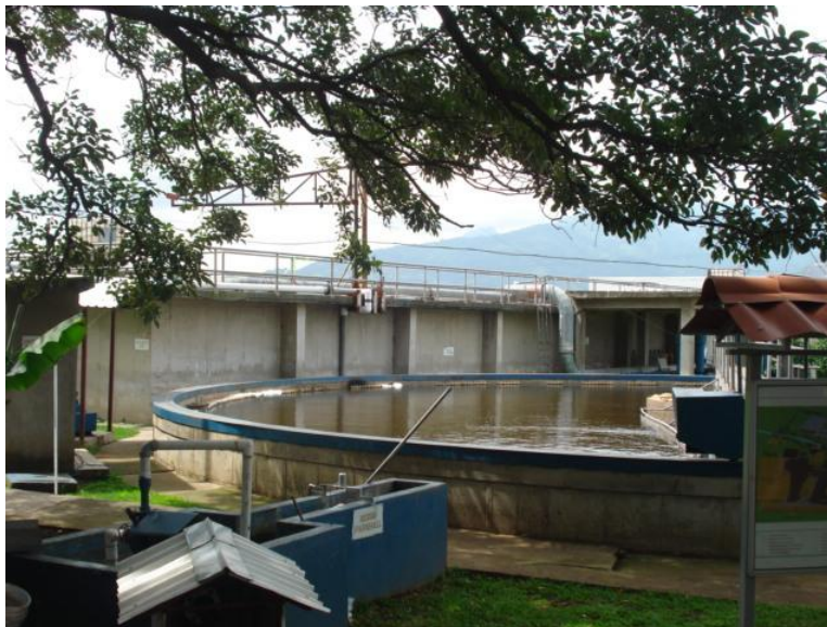
Fotografía 2-6. Reactor de lodos activados y clarificador circular.
