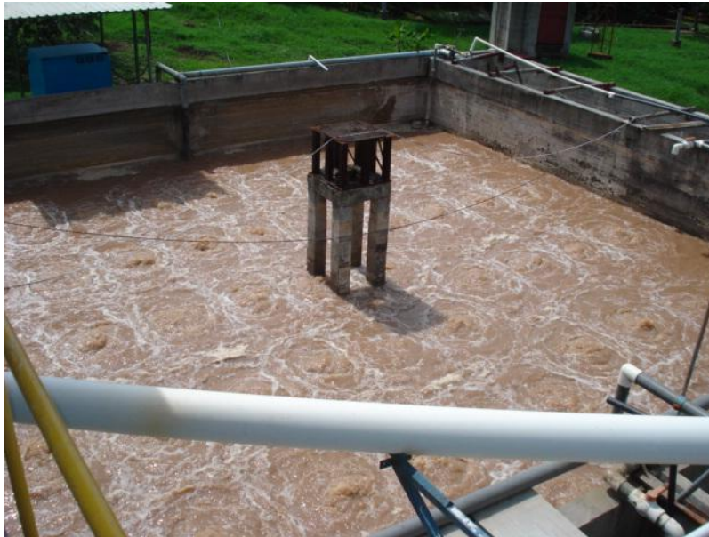
Fotografía 2-4. Tanque de ecualización de aguas residuales.
