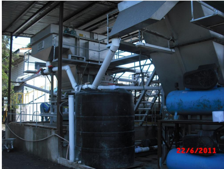
Fotografía 2-5. Sistemas de flotación por aire disuelto.
