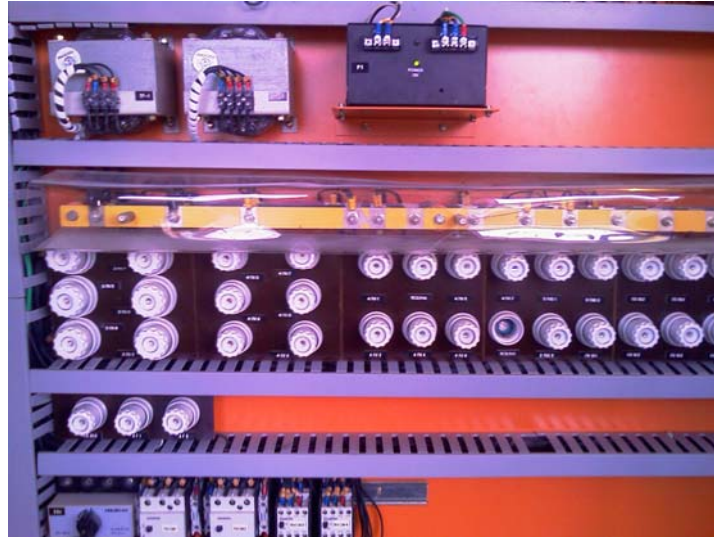
Figura 5.1. Fusibles del sistema de control.
