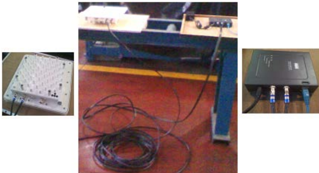
Figura 5.18. Conexión de cables coaxiales dobles con conectores tipo F entre radio y el inyector de corriente.
