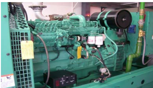
Figura 1.1.3 Vista lateral izquierda del generador de la planta de emergencia.
