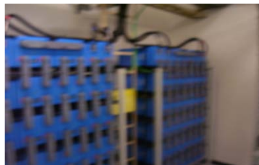
Figura 1.1.8 Banco de baterías para equipo de Cable Maya.
