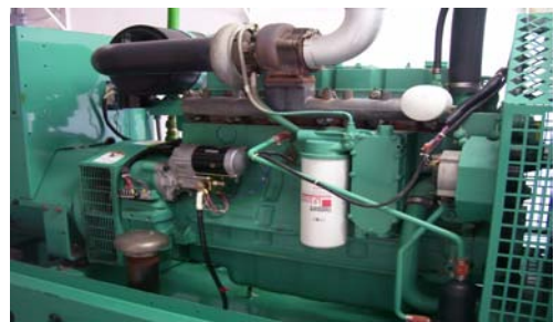
Figura 1.1.4 Vista lateral derecha del generador de la planta de emergencia.
