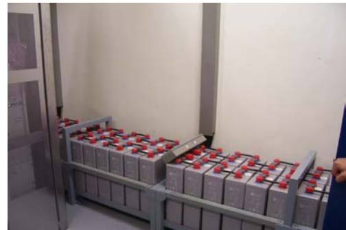
Figura 1.1.7 Banco de baterías para equipo de Cable Arcos.
