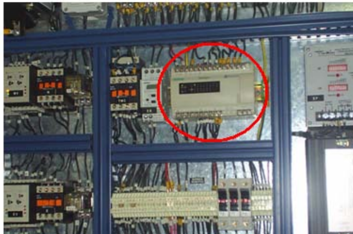
Figura 5.2.9.1.4 Ubicación de la lógica de relés utilizados para iniciar o finalizar un proceso completo de arranque de planta y transferencia de energía.
