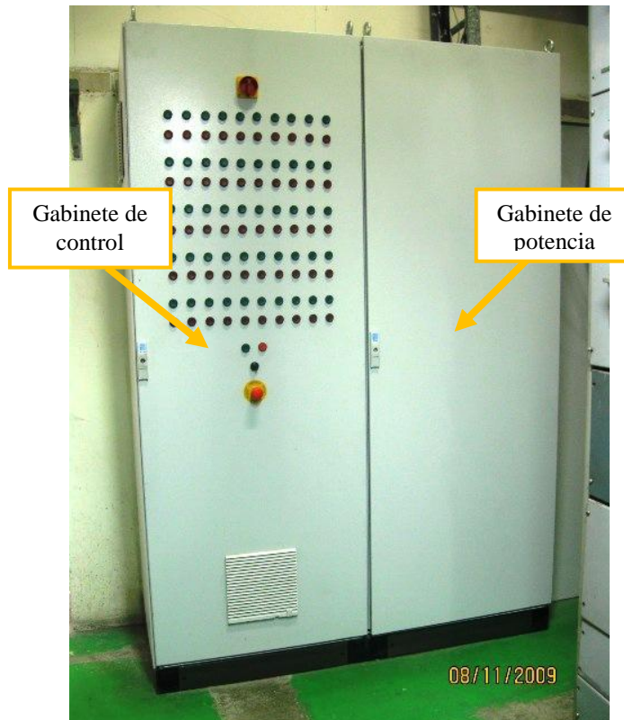
Figura 5.1 Gabinete de control y gabinete de potencia
