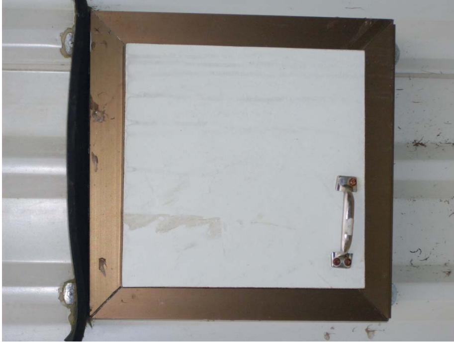
Figura 3-4 Ventilación de apertura manual existente.
