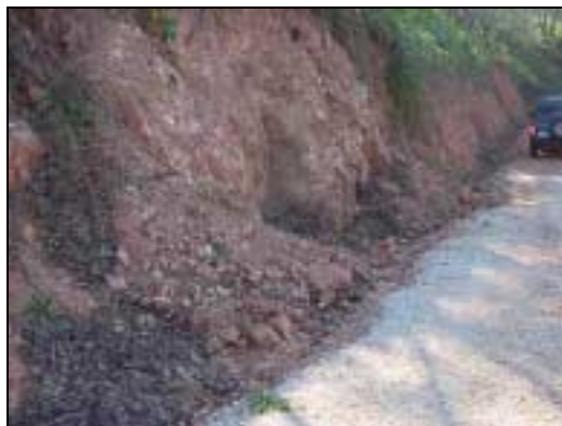
Figura GUA 021-3. Cunetas dañadas y derrumbes producto de la erosión de los taludes.
