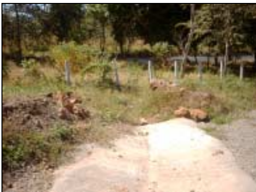
Figura GUA 048-2. Paso de aguas se debe alargarse hasta la calle principal.
