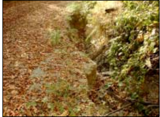
Figura PUN 012-1. Camino público deteriorado; agua que corre por las cunetas naturales erosiona la calzada.
