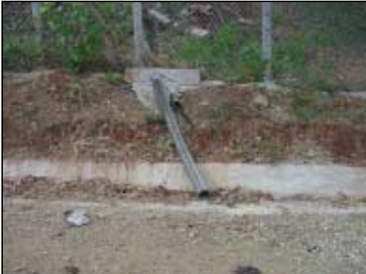
Figura PUN 013-1. Tipo de evacuación de aguas inadecuado.
