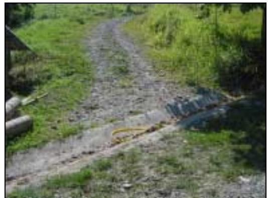
Figura PUN 041-1. Paso de aguas construido incorrectamente.
