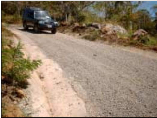
Figura GUA 048-1. Tramo del camino sin una base mejorada con cemento.
