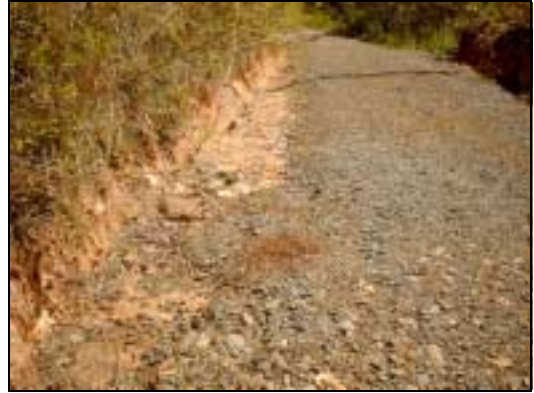
Figura PUN 020-2. Cunetas naturales que no se encuentran bien realizadas.
