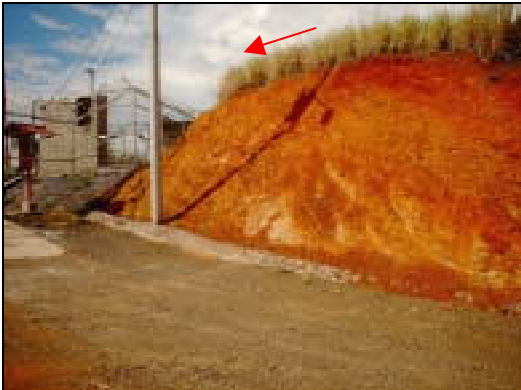
Figura PUN 054-2. Talud con erosión.
