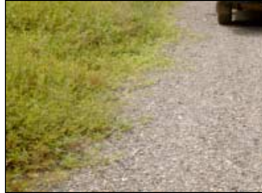
Figura PUN 027-1. Camino en zona inundable.
