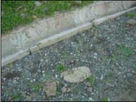
Figura LIM 006-1. Cuneta de medio tubo quebrada por encontrarse el borde expuesto.
