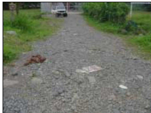
Figura LIM 003-1. Camino no conformado según especificaciones técnicas.
