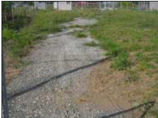
Figura GUA 028-1. Camino mal conformado.
