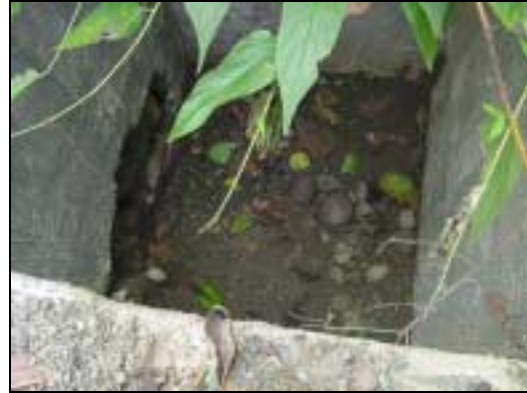
Figura LIM 010-3. Material grueso depositado en el interior de los registros.
