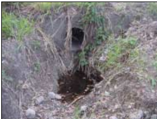
Figura GUA 052-5. Socavación a la salida de las aguas en la alcantarilla de paso.
