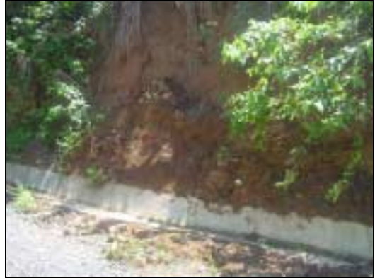
Figura LIM 017-2. Desprendimiento de material en algunos tramos del talud.
