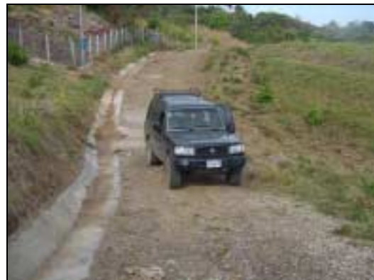
Figura PUN 013-3. Cuneta de concreto con geometría que no cumple su función recolectora de aguas.
