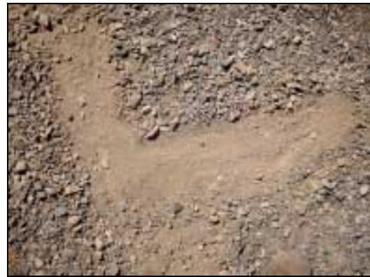
Figura PUN 008-1. Material granular suelto en la superficie del camino.
