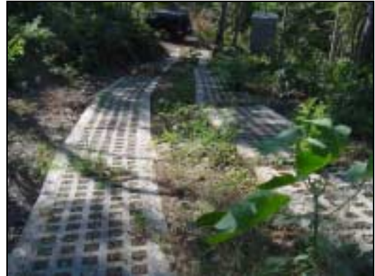
Figura GUA 025-2. Muestra las huellas de concreto a 90 grados respecto a la línea del camino.
