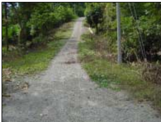
Figura LIM 010-2. Camino con pendiente mayor a 25% con su base deteriorada.
