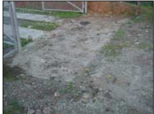
Figura LIM 006-4. Cuneta con rejilla metálica no construida en la entrada a la celda.
