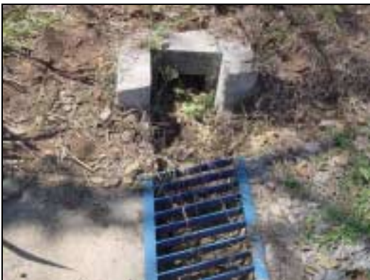
Figura PUN 055-1. Falta de mantenimiento en general.
