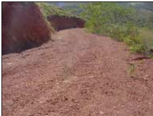
Figura GUA 021-1. Situación actual en sitio de una sección del camino que debiera estar con lastre-cemento.
