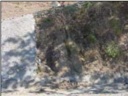
Figura GUA 010-4. Revestimiento socavado en el talud.
