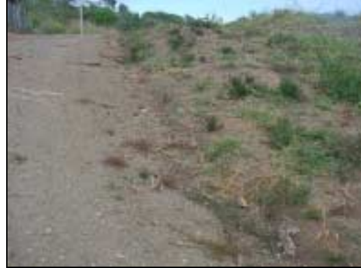
Figura PUN 013-2. Cuneta rayada no definida correctamente.
