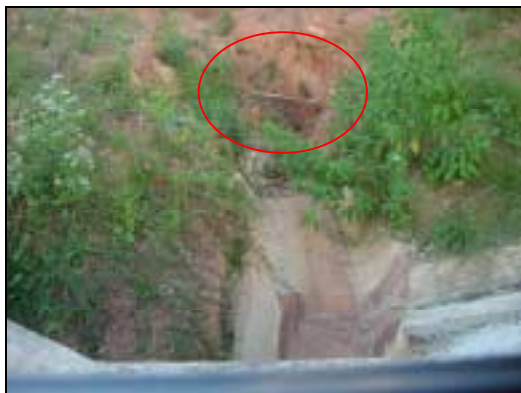
Figura PUN 053-1. Alcantarilla sustituta del paso de aguas natural.
