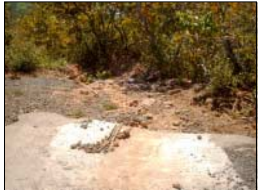
Figura PUN 020-3. Paso de aguas con insuficiente longitud.
