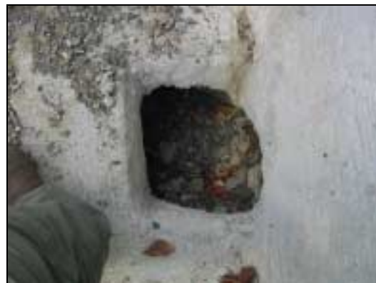
Figura LIM 010-4. Registro construido inadecuadamente.
