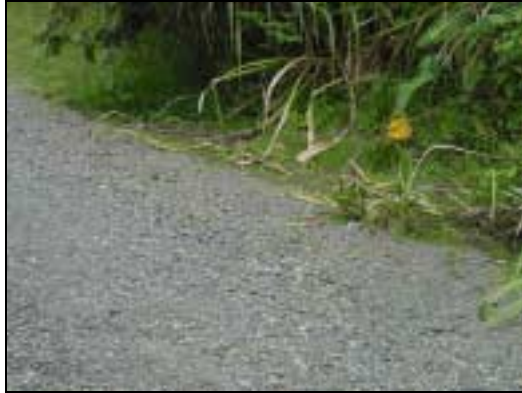
Figura LIM 018 -1. Ausencia de cunetas.
