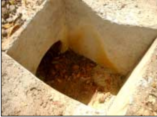
Figura PUN 044-3. Material depositado en el interior del registro.
