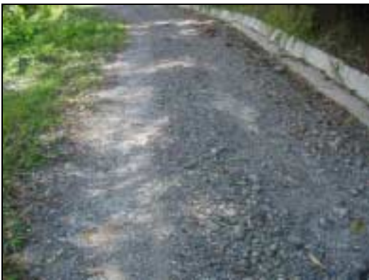
Figura LIM 017-1. Deterioro del camino con base estabilizada.
