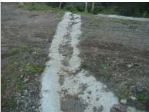
Figura LIM 006-3. Paso de aguas deteriorado.
