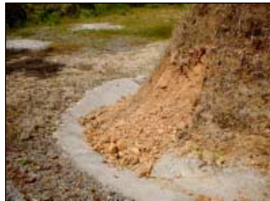
Figura PUN 044-2. Erosión de los taludes.
