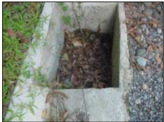
Figura LIM 017-3. Caja de Registros con material grueso depositado en su interior.
