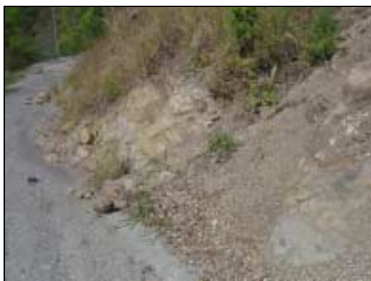
Figura GUA 10-1. Material desprendido de los taludes
