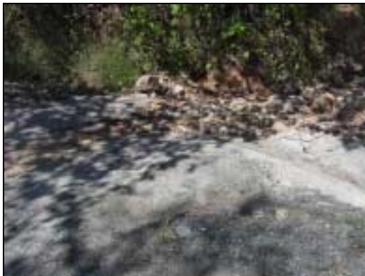
Figura PUN 020-5. Paso de agua dañado en ambos extremos.
