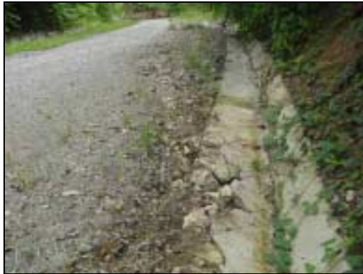
Figura LIM 010-1. Cuneta destruida que incide en la erosión del camino.
