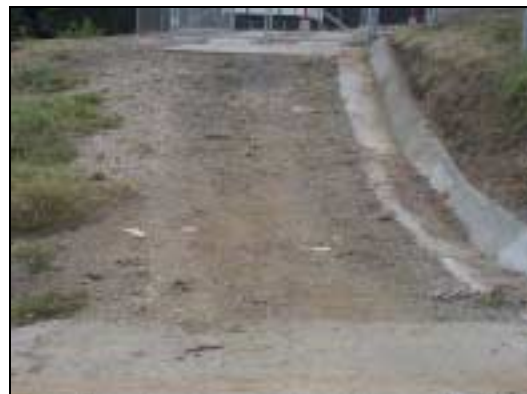
Figura PUN 013-4. Base del camino con material suelto.
