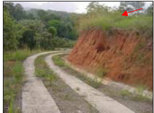
Figura PUN 050-1. Taludes erosionados.
