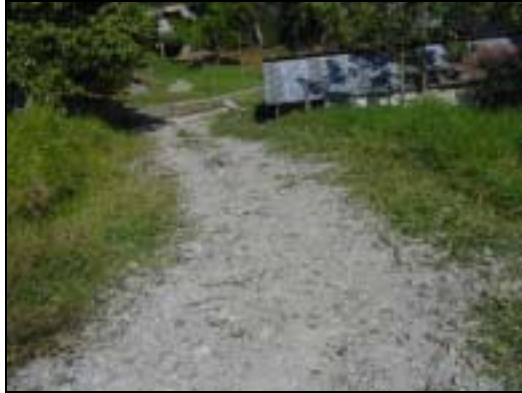
Figura PUN 041-2. Base del camino y cunetas naturales mal conformadas.
