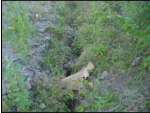
Figura GUA 052-3. Cunetas rayadas mal conformadas y obstruidas en varios tramos.
