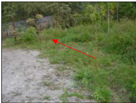
Figura GUA 052-4. Aguas mal encausadas a la cuneta de la vía principal.
