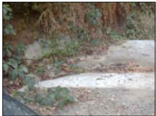
Figura PUN 012-2. Pasos de agua sin un dispositivo que impida que la corriente continúe por la cuneta.
