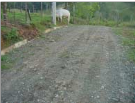
Figura LIM 006-2. Cuneta bloqueada en varios tramos.
