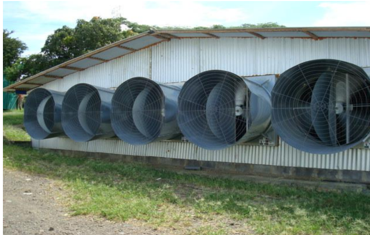
Figura 7. Extractores utilizados en el sistema de túnel. Tomada con cámara digital. Granja Potrerillos PIPASA S.A. (Elizondo 2009).
