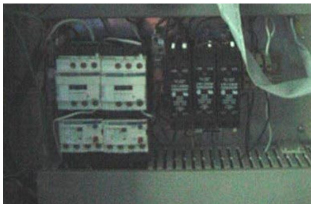
Figura 6.4 Sistema de Potencia
