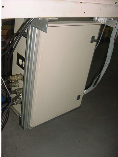
Figura 5.4 Gabinete del nuevo controlador
