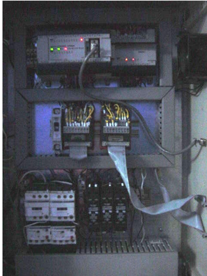
Figura 6.1 Controlador con PLC
