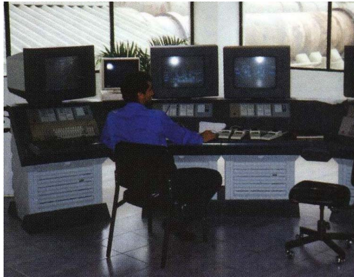
Figura 1.4 Sala de control de la planta
