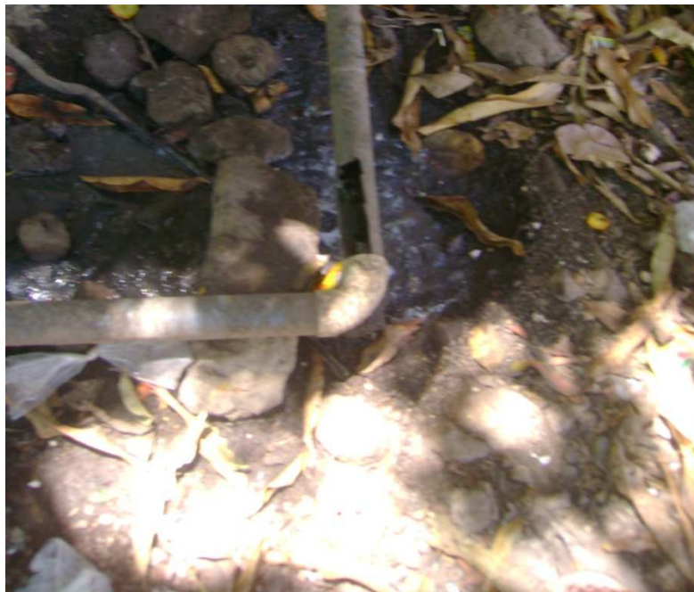
Fuente: Moncada, S Figura 3. Tubería de entrada a pretratamientos en mal estado, encuesta No.3.
