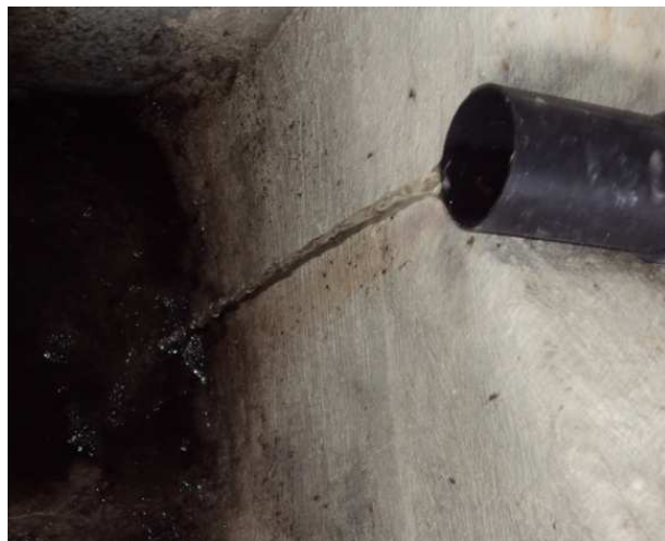
Figura 6. Salida del efluente del biodigestor.
