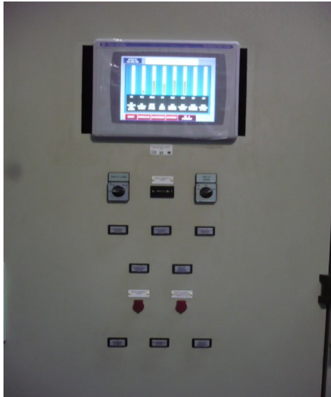
Figura A.10 Panel de Mando y Alarmas con la pantalla PanelView Plus 1000.
