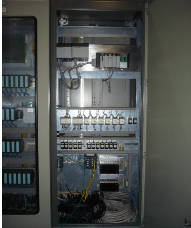
Figura A.8 Gabinete con el PLC ControlLogix y las fuentes redundantes.
