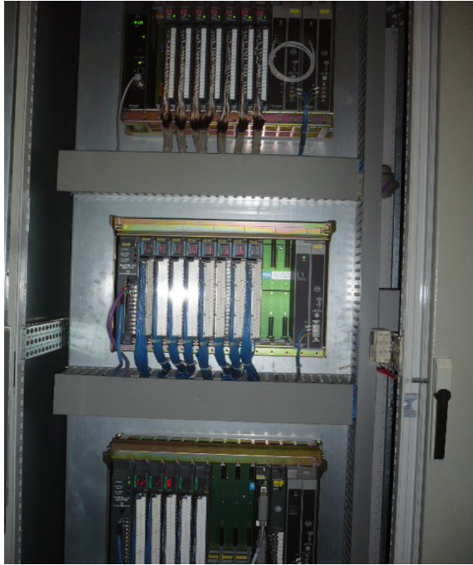
Figura A.9 Gabinete con los módulos I/O 1771 remotos.
