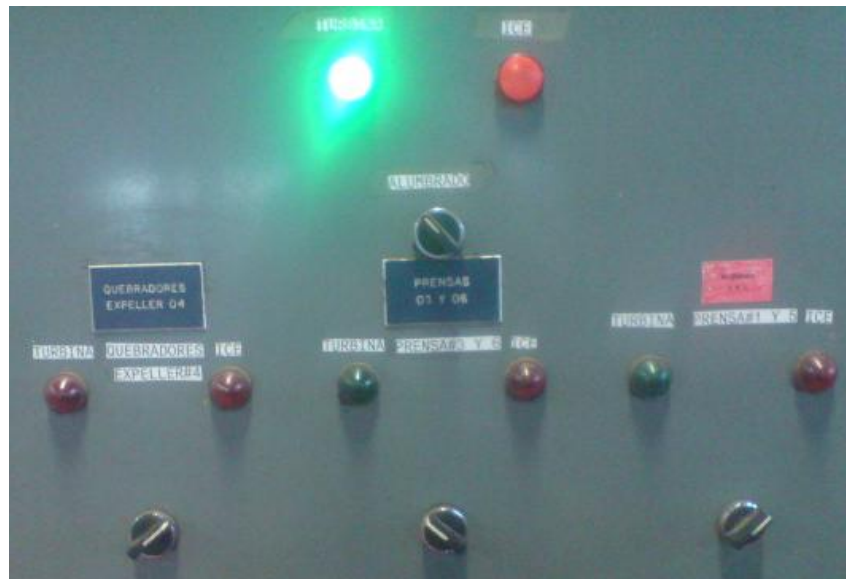
Figura 1.2 Fotografía de una sección del tablero de transferencias.
