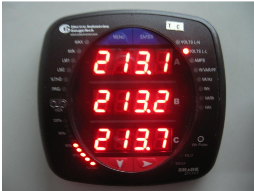
Figura A.4.3 Medición de voltaje de línea realizada con el analizador de calidad de energía Shark 200.
