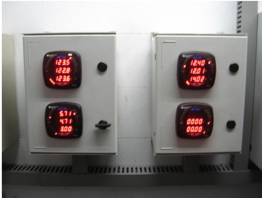
Figura 6.3 Funcionamiento normal de los analizadores de calidad de energía Shark 200.
