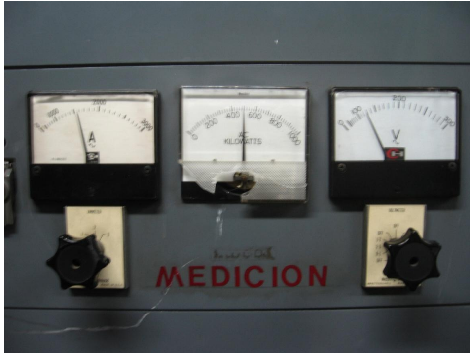
Figura 5.7 Antiguo sistema de medición ubicado en la subestación eléctrica.
