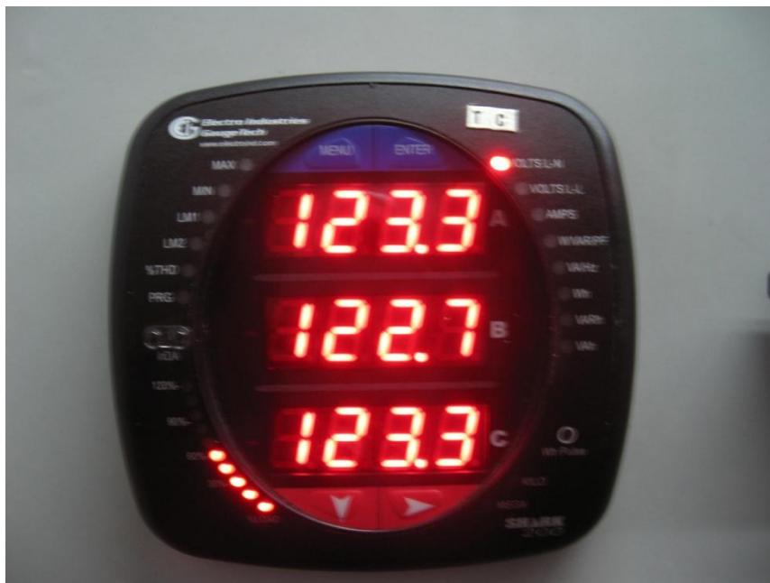
Figura A.4.4 Medición de voltaje de línea realizada con el analizador de calidad de energía Shark 200.
