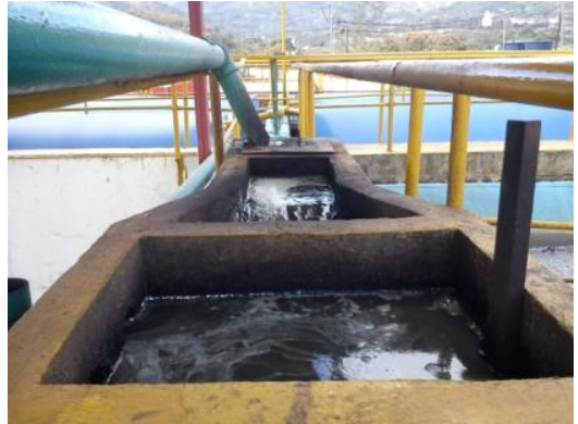
Tanque de distribución de caudales con la tabla obstruyendo la entrada del tercer módulo.
