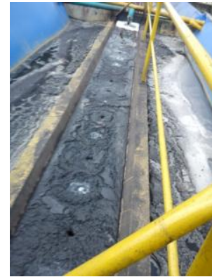
Vista de la canaleta de entrada del afluente al reactor cubierta con una capa sólida que obstruía el paso del agua a través de los tubos de alimentación.
