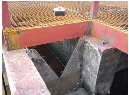
Vertedero de entrada contiguo al tanque de entrada. Aquí fueron medidos los DQO de entrada.
