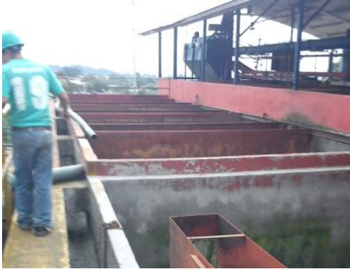
Vista lateral del sedimentador primario.
