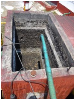
Tanque de entrada del agua residual si diluir, ubicado posterior al tamiz rotatorio.
