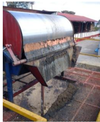
Tamiz rotatorio ubicado antes del reactor anaerobio de flujo ascendente
