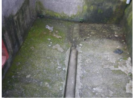
Interior de una de los compartimientos del sedimentador primario.
