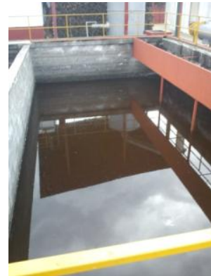
Obsérvese el agua que ingresó al tanque pulmón a inicios de arranque. Foto capturada el 18 de agosto del 2011.
