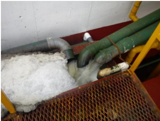
Salida de efluente de los 3 módulos del reactor anaerobio de flujo ascendente
