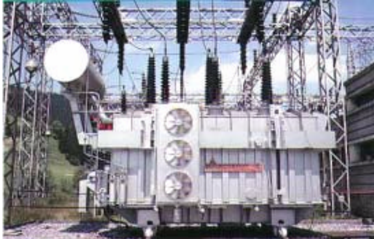
Figura 4.1 Transformador de Potencia
