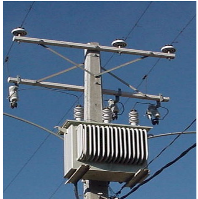
Figura 4.2 Transformador de Distribución
