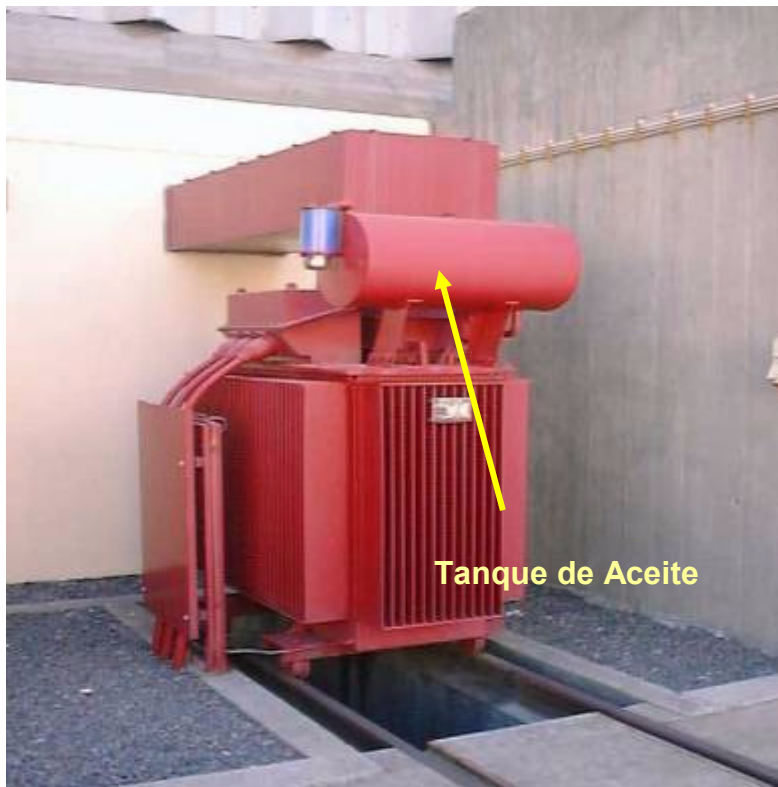
Figura 4.5 Transformador Trifásico "de Aceite"
