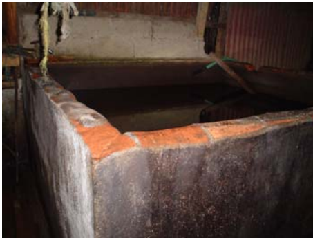
Tanque de preenfriamiento
