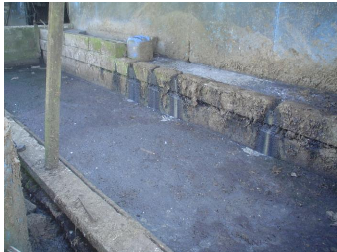
Figura 24. Pileta de almacenaje de la cerdaza.
