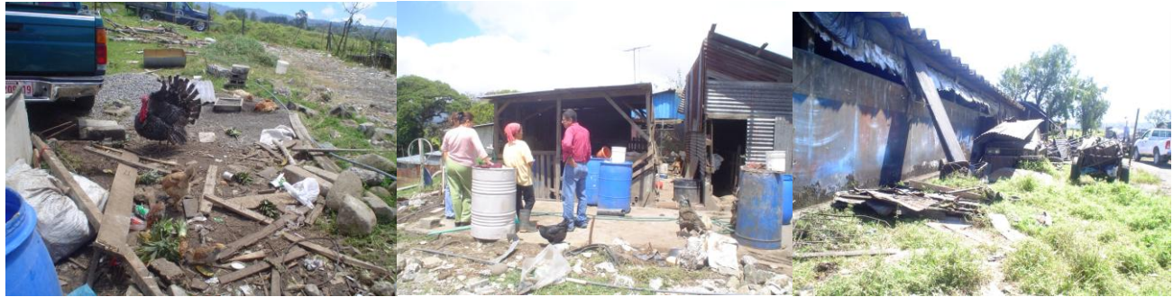
Figura 7. Alrededores del galerón con escombros y desechos.
