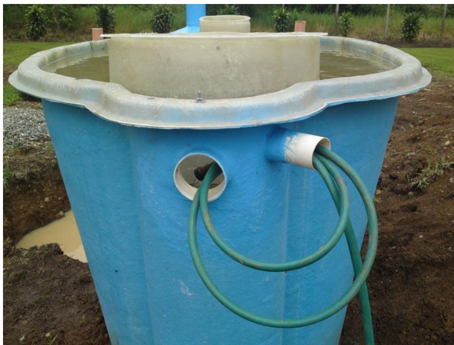
Figura 4. Alimentación de agua residual del sistema experimental. Entrada en tanque de sedimentación.
