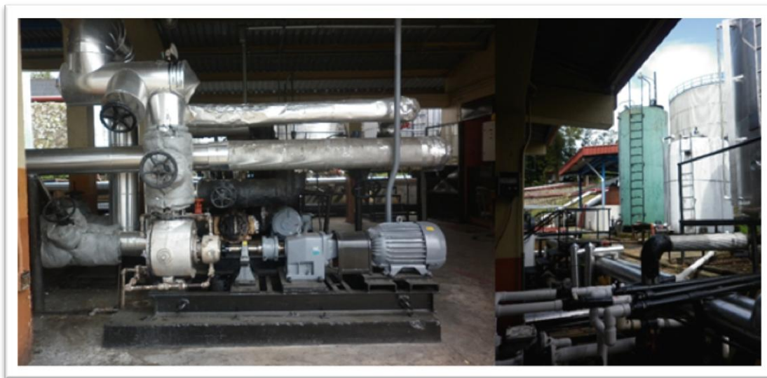
Figura N°8. Planta de Emulsión Asfáltica del Plantel El Alto, RECOPE.
