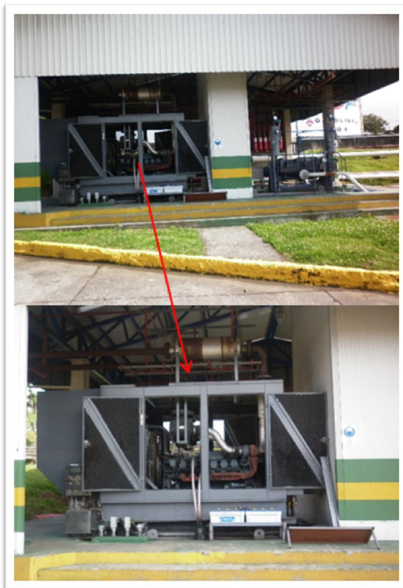
Figura N°6. Motor MP-3 del área de bombeo del Plantel El Alto, RECOPE.
