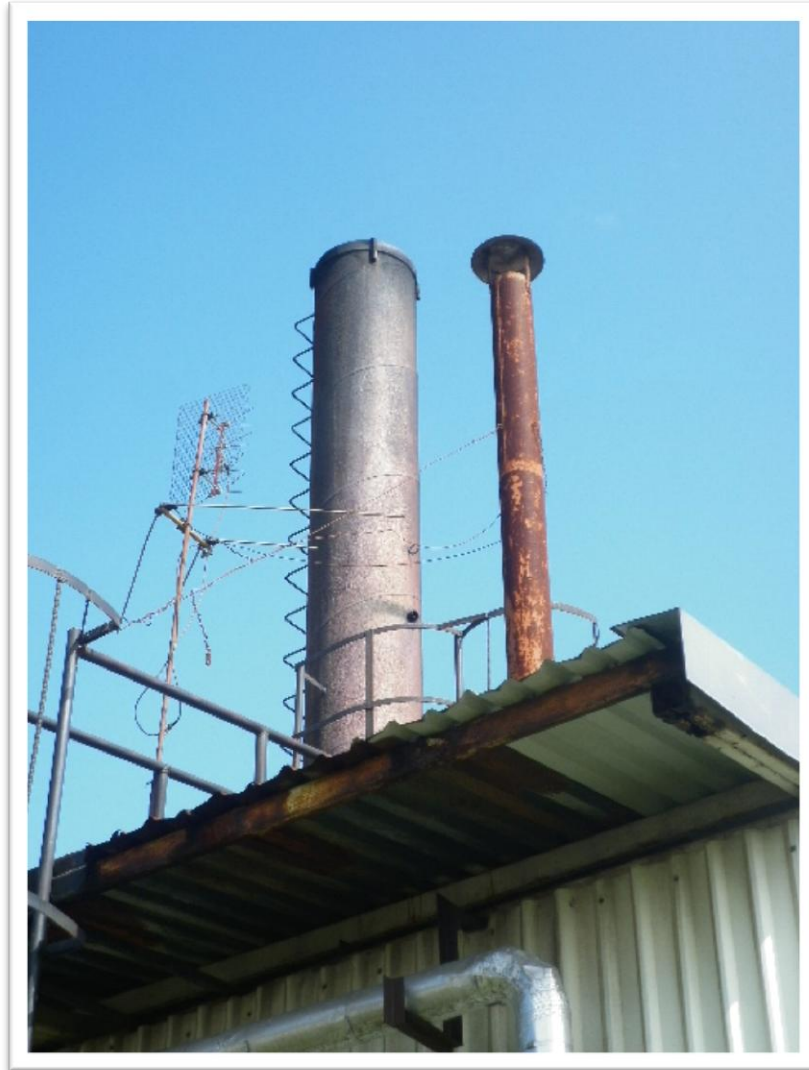
Figura N°15. Chimeneas de las calderas del Plantel El Alto.
