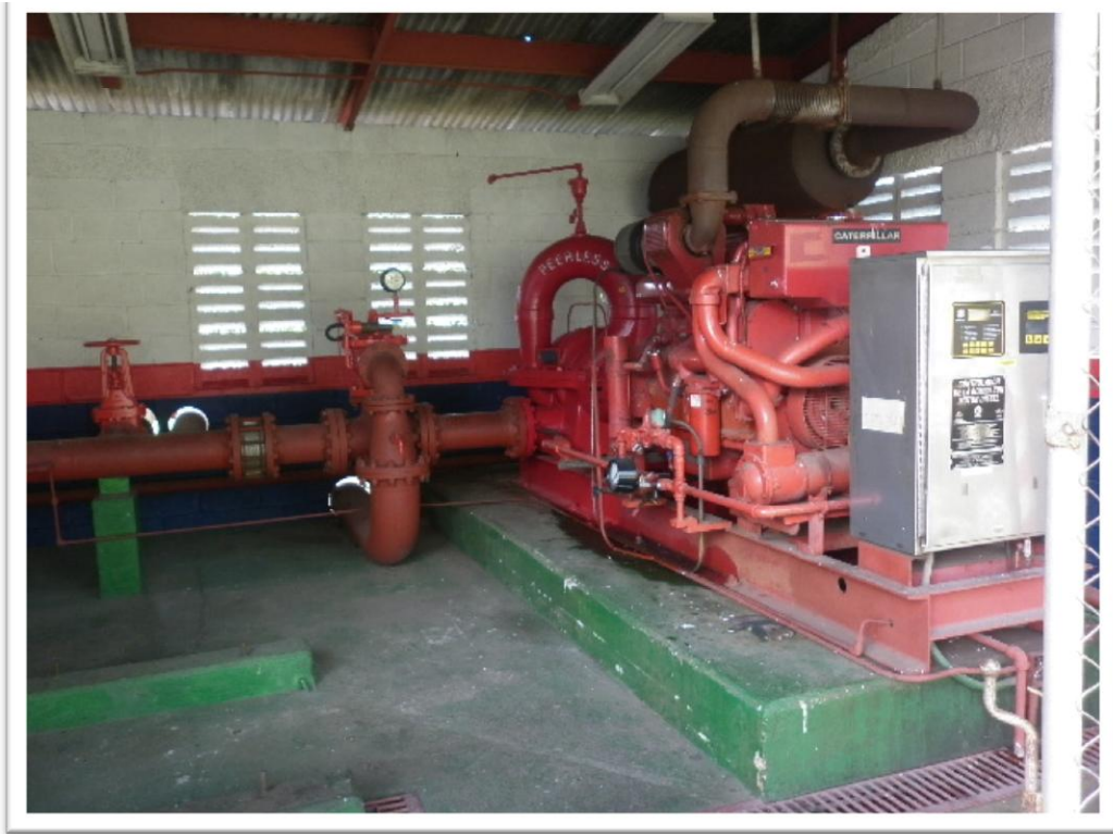
Figura N°7. Motor del Sistema contra Incendios del Plantel El Alto, RECOPE.
