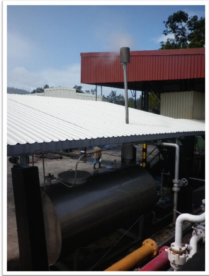
Figura N°14. Tanque de recolección de condensados del Sistema de vapor
