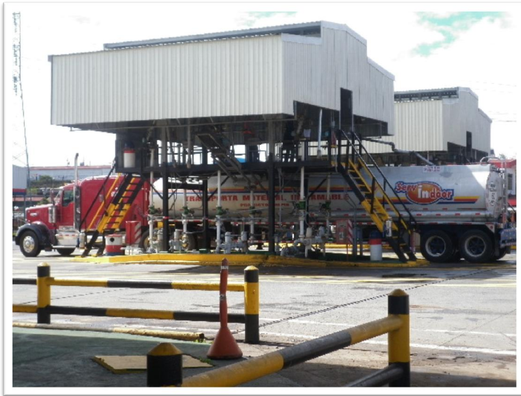
Figura N°9. Área de cargaderos de combustible del Plantel El Alto.
