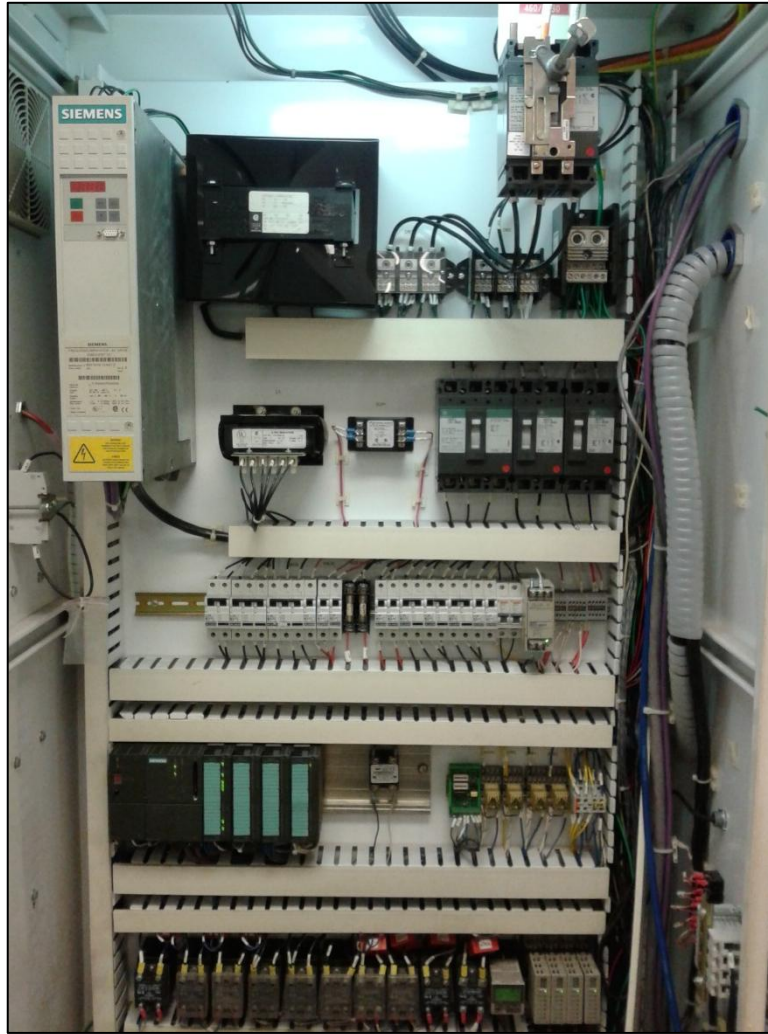
Figura 3.11. Parte interna del gabinete de control de la extrusora
