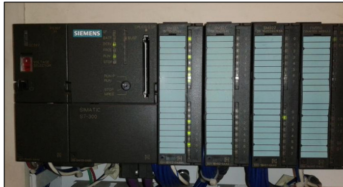
Figura 3.21. PLC Siemens Simatic S7-300 y sus cuatro módulos adicionales
