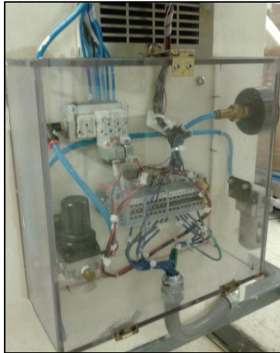
Figura 3.6. Gabinete del control neumático del brazo.
