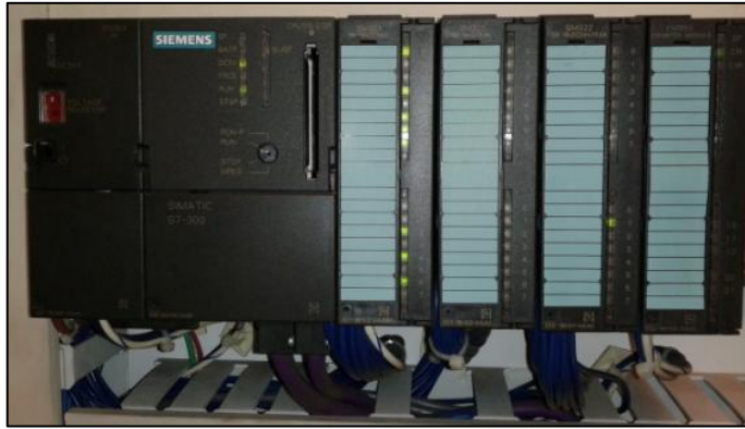
Figura 5.5. PLC Siemens Simatic s7-300, utilizado para implementar la solución.
