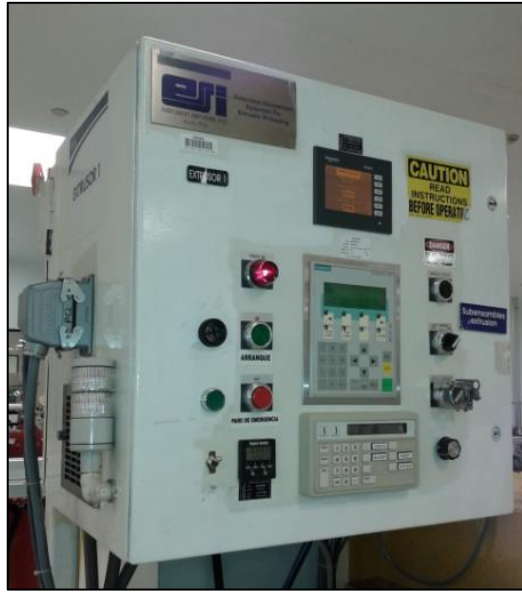
Figura 3.17. Parte externa del panel de control del eje 4 y de la guillotina.
