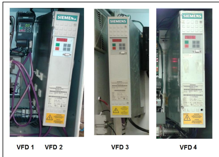
Figura 5.8. Variadores de frecuencia que controlan cada uno de los motores.
