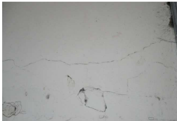
Figura 60. Agrietamiento en paredes debido a falta de continuidad.
