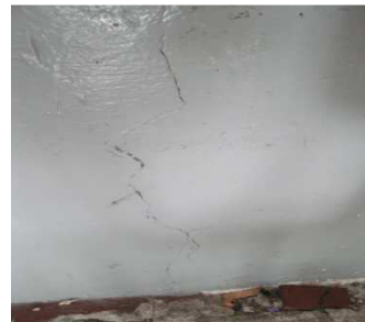
Figura 68. Grieta en pared transversal
