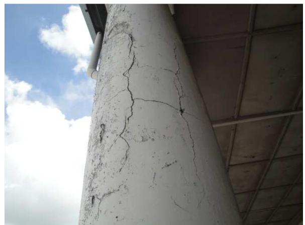
Figura 63. Agrietamiento columna circular con probable efecto de laminación
