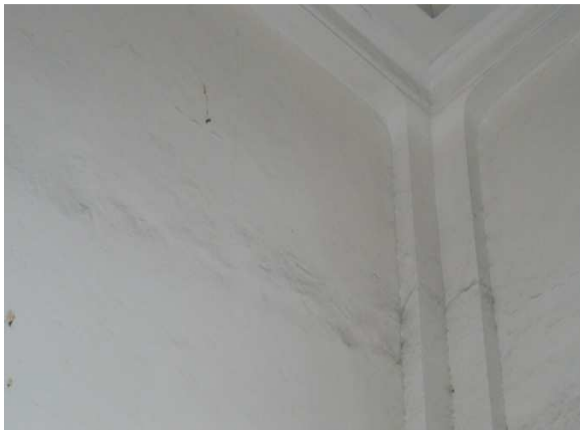
Figura 55. Agrietamiento horizontal en las paredes
