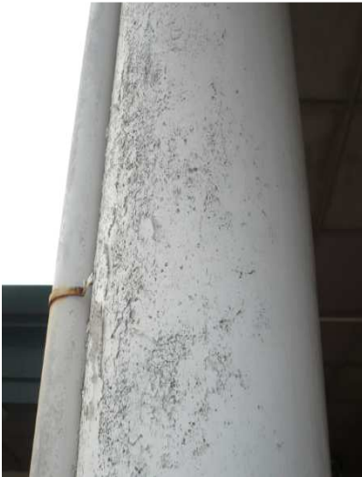
Figura 64. Corrosión en las uniones de los elementos metálicos.
