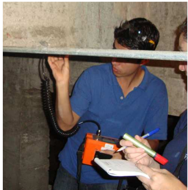
Figura 17. Detección de acero a una viga de entrepiso en el sector norte del edificio
