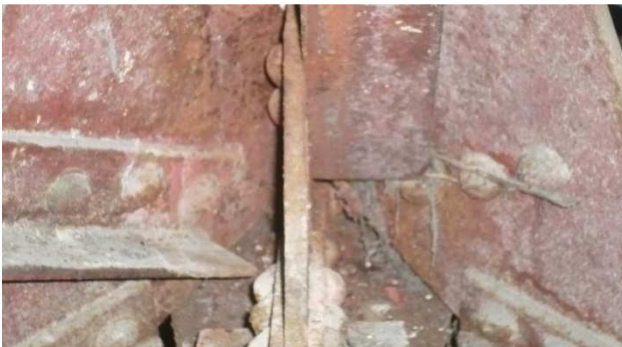
Figura 65. Corrosión en la estructura metálica.
