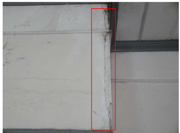
Figura 62. Daños en ángulos de paredes
