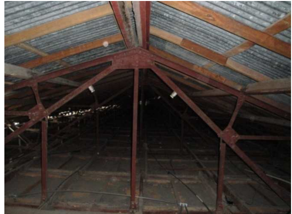
Figura 57. Presencia de dos bloques de cerchas sin tensores y con alto nivel de corrosión. (Generalizado en todo el edificio)
