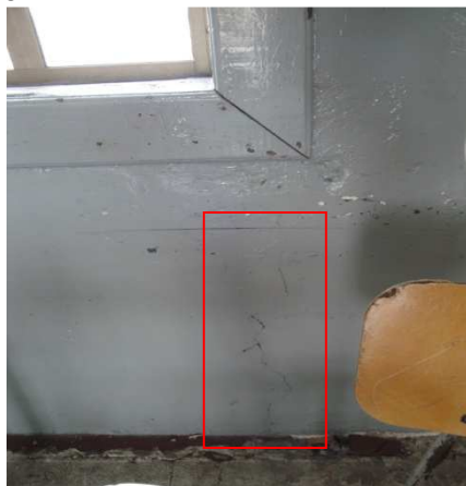
Figura 56. Grieta estructural en pared
