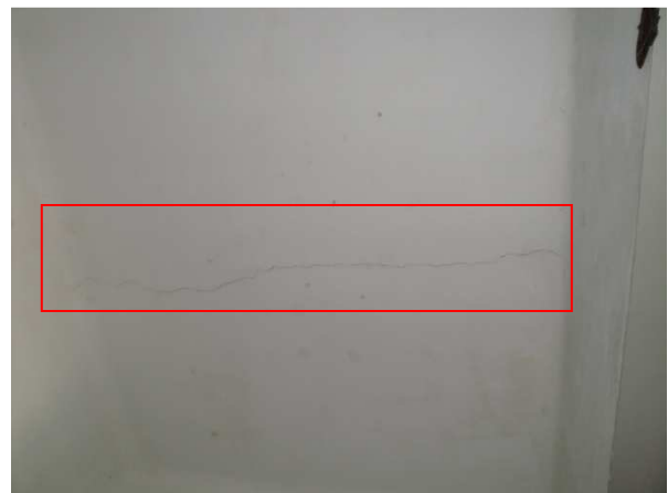
Figura 54. Fisura en repellos
