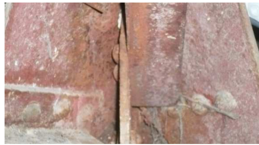
Figura 66. Corrosión en la estructura metálica.
