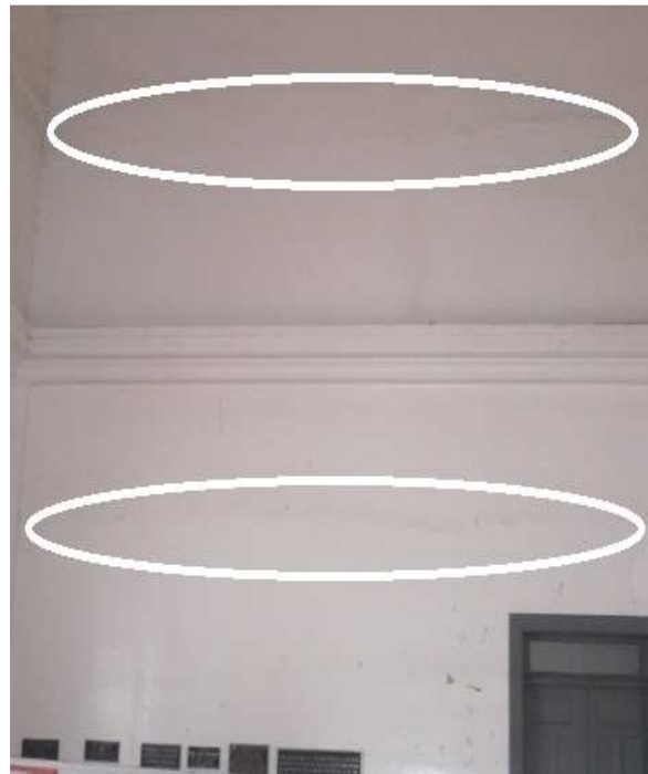
Figura 58. Agrietamiento en las paredes por falta de continuidad de elementos
