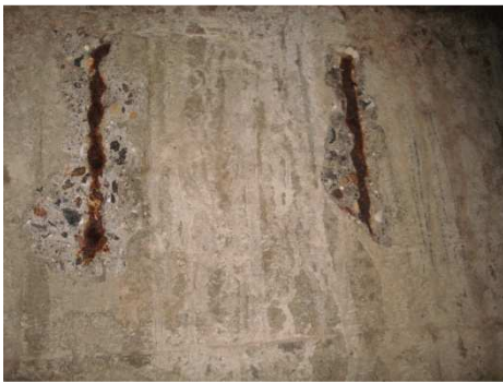
Figura 49. Varillas expuestas de entrepiso de sótano norte
