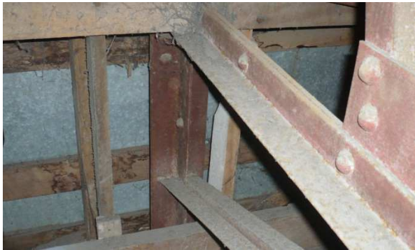
Figura 59. Corrosión en la estructura metálica.
