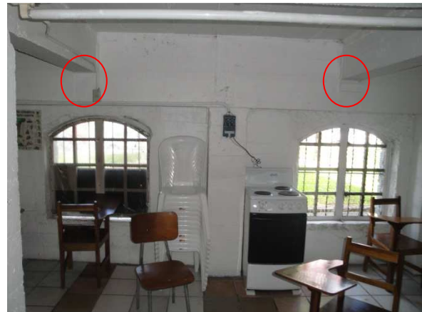
Figura 53. Vigas de entrepiso fuera de eje
