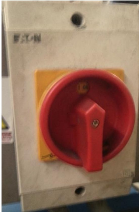
Figura 30 Caja de paso de los motores
