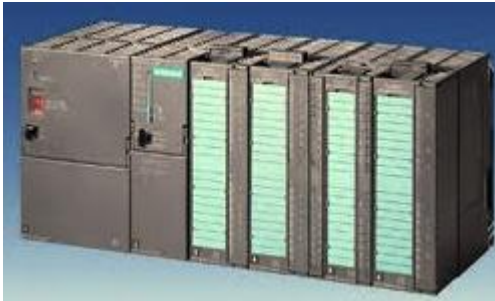
Figura 34. Unidad de control del sistema, PLC S7
