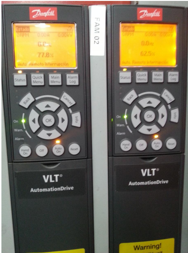
Figura 46. Variadores ya configurados y trabajando en modo automático
