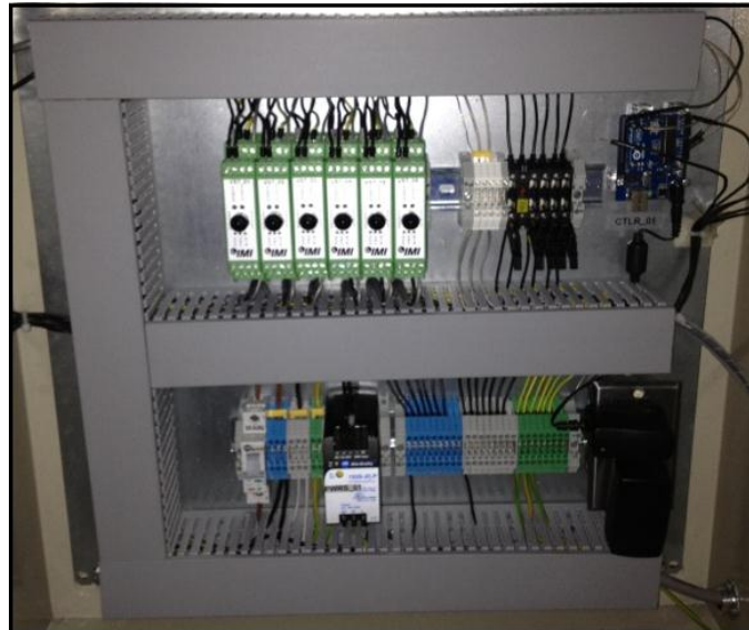
Figura 5.7 Gabinete del sistema de monitorización de vibraciones.
