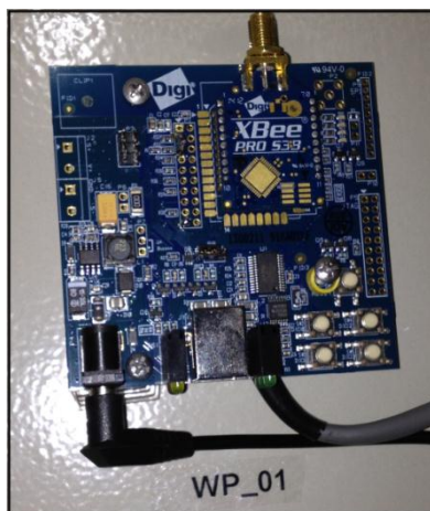
Figura 5.8 Montaje de Xbee PRO XSC en panel.
